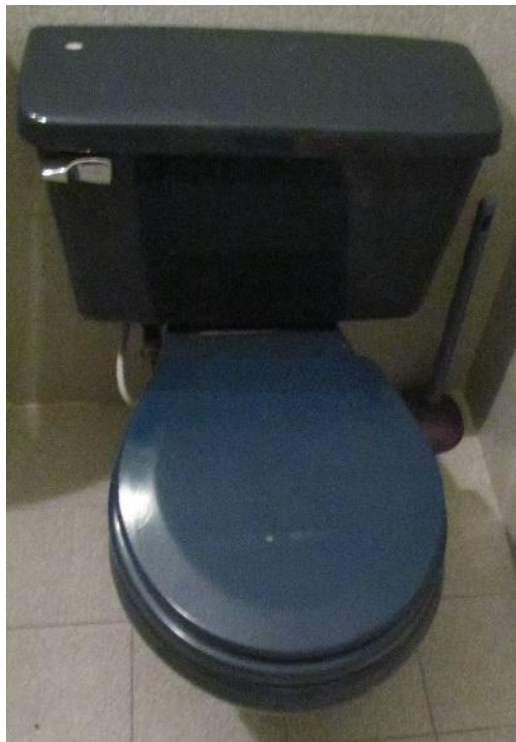
Figura 25. Unidad sanitario convencional administrativos
