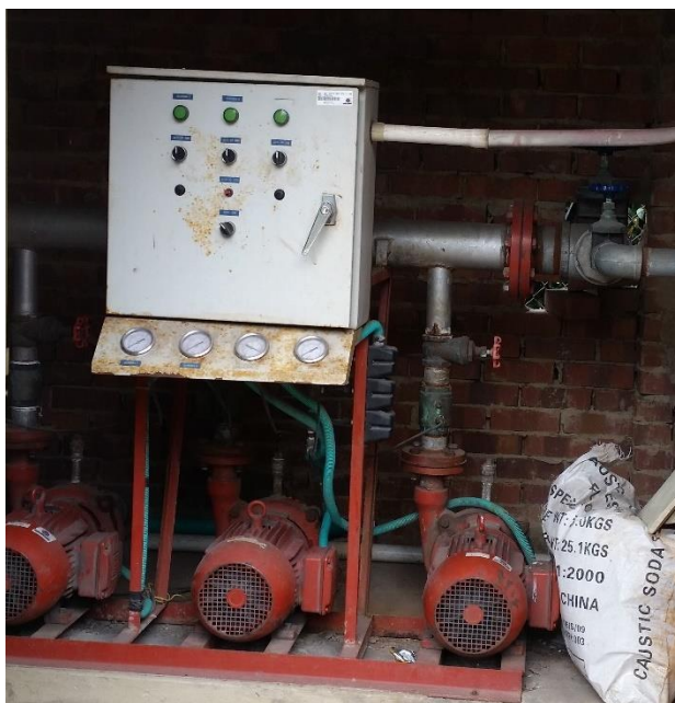
Figura 6. Cuarto de máquinas manejo EDAR clausurada
