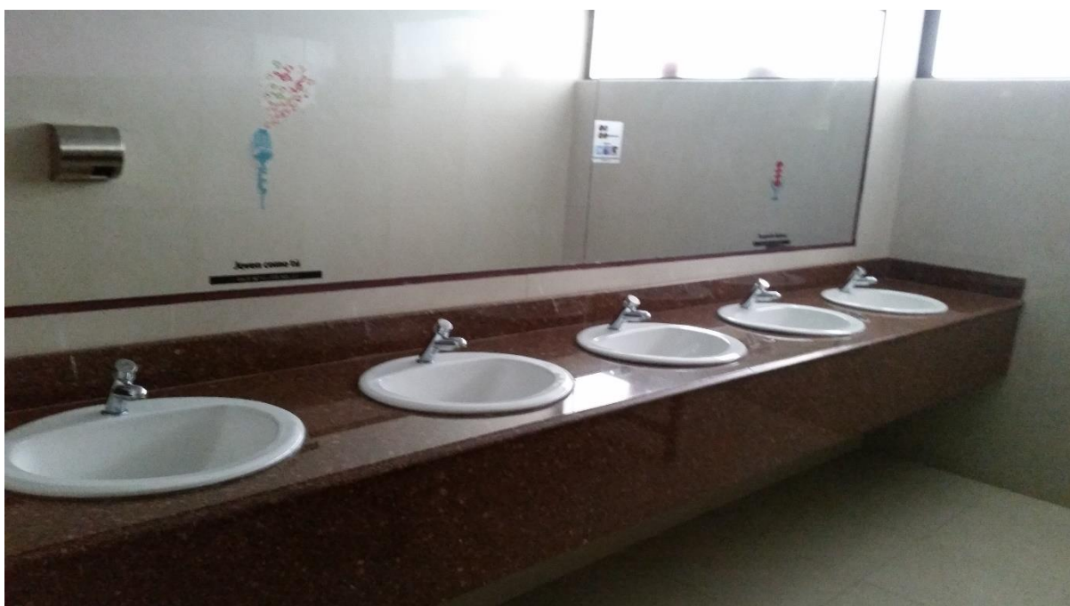
Figura 4. Lavamanos push campus San Alberto Magno
