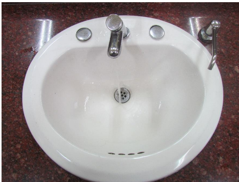
Figura 28. Lavamanos convencional edificio C
