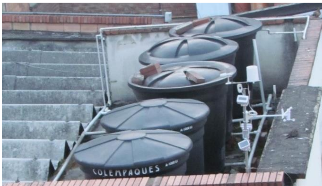
Figura 23. Tanques de almacenamiento elevados edificio F sede central
