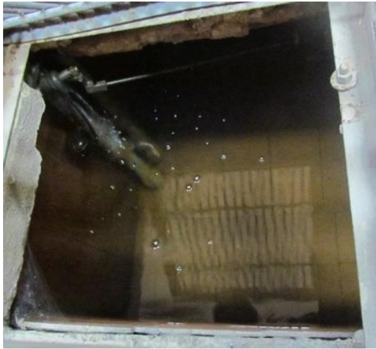
Figura 24. Tanque edificio Laboratorios
