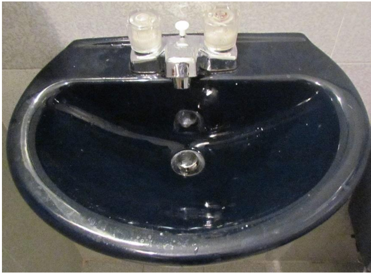
Figura 26. Unidad sanitario convencional administrativos
