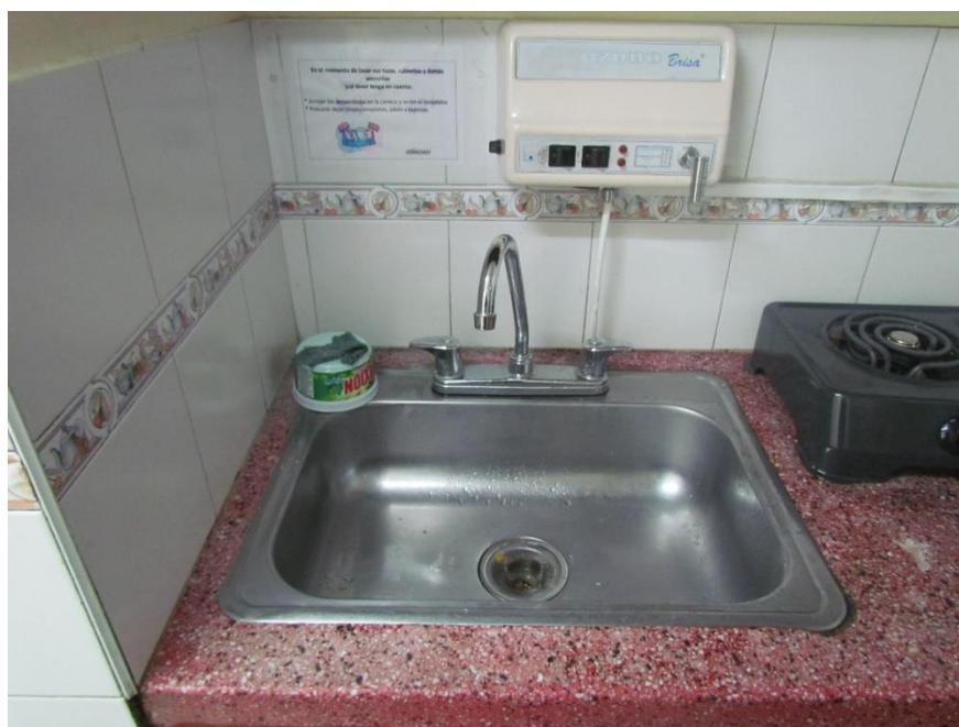
Figura 55. Cocineta y lavaplatos en la sede
