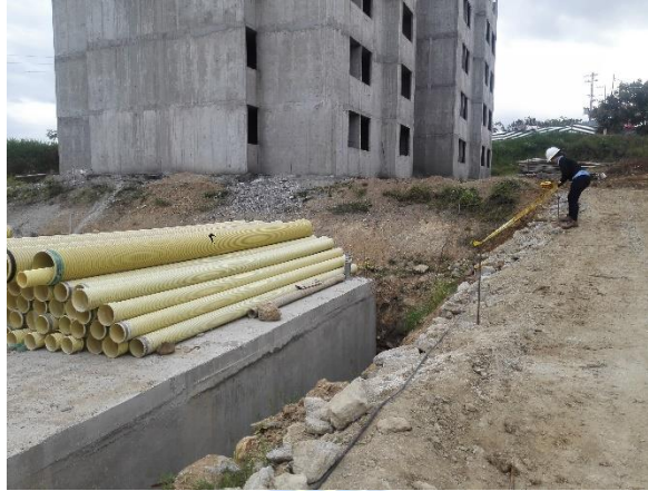
Figura 5. Tanque y tubos de aguas. Fuente autor
