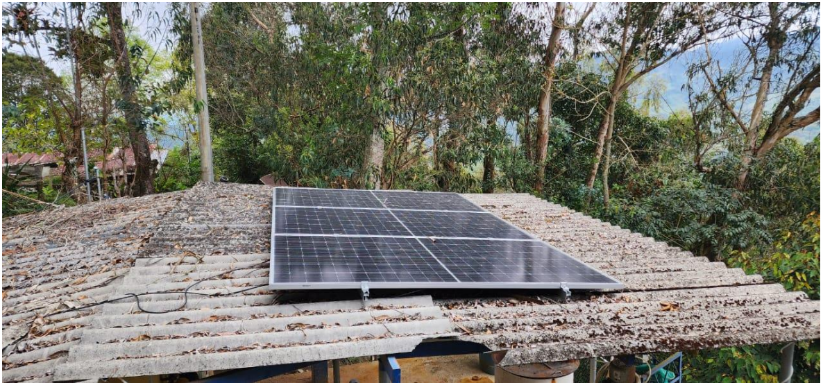
Ilustración 8. Paneles solares en la PTAP de Supatá. Elaboración: Fuente propia.
