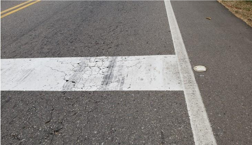
Figura 24. Muestra de fallas en la carpeta asfáltica.
