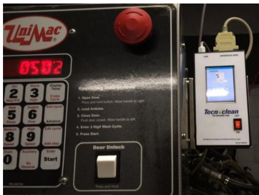
Figura 27 Instalación de programador y cable de señal
