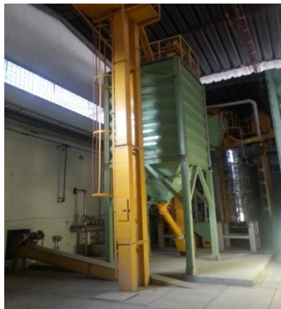
Figura 1. Cooker o inactivador de frijol soya instalado en planta.
