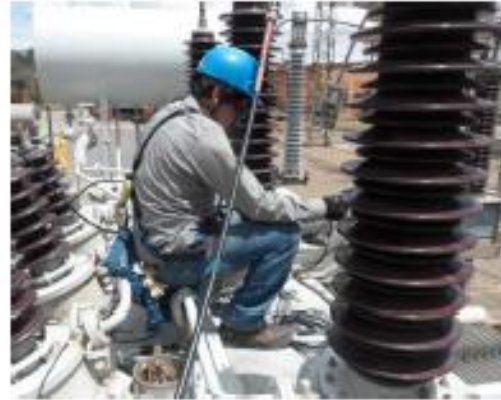
Foto 2-3-4. Pruebas eléctricas a transformador
