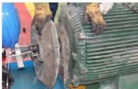
Foto 7. Retiro ventilador ventilador
