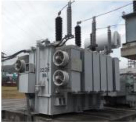
Foto 1. Ubicación del transformador
