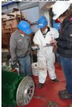
Foto 15. Pruebas eléctricas finales
