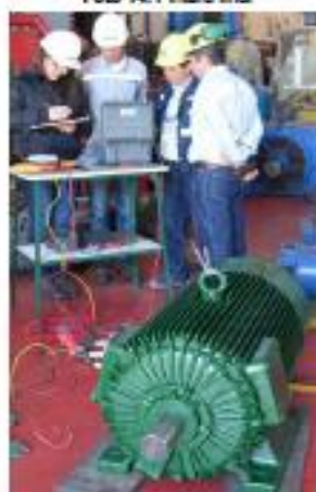
Foto 16. Pruebas eléctricas finales
