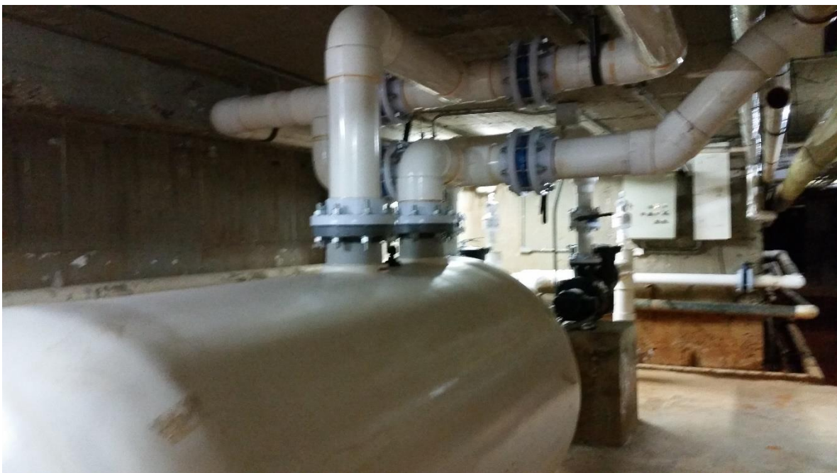
Figura 4. Tanque recirculación piscina
