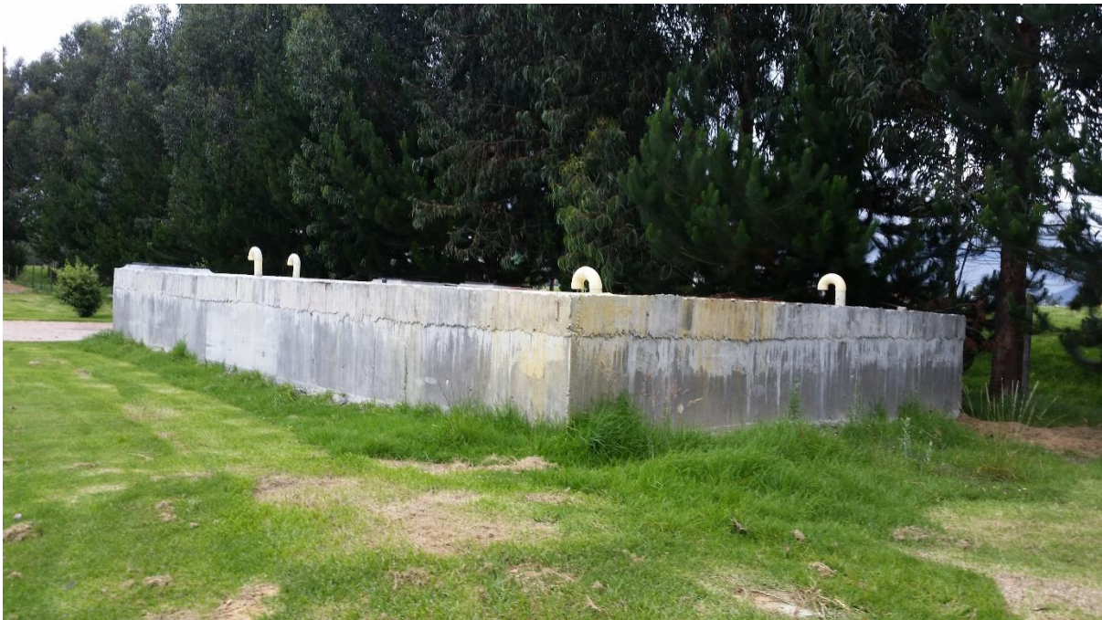
Figura 23. Tanque de almacenamiento de aguas lluvia
