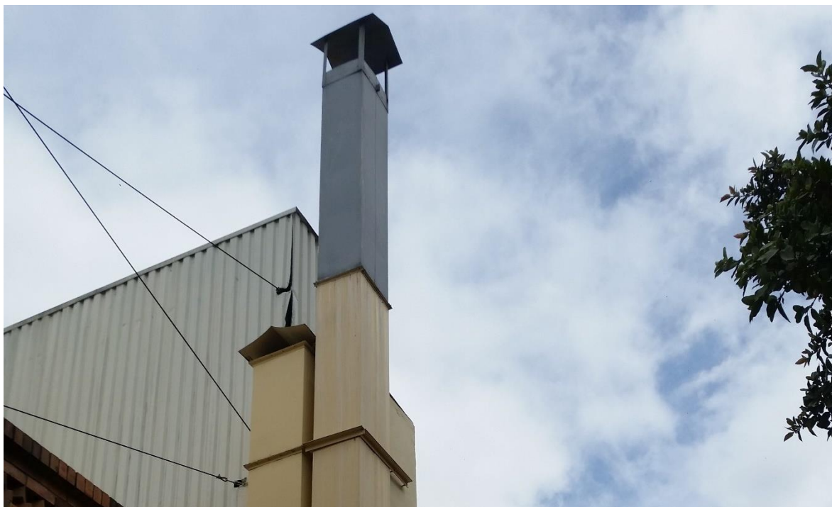
Figura 26. Chimenea por fuera de los límites permisibles
