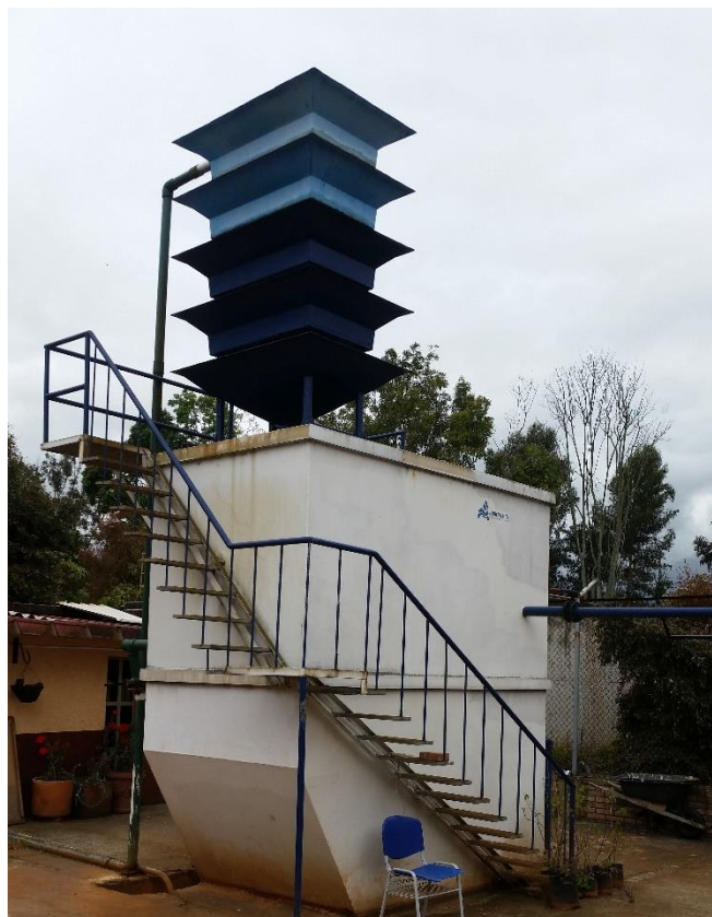
Figura 15. Condiciones de la PTAP
