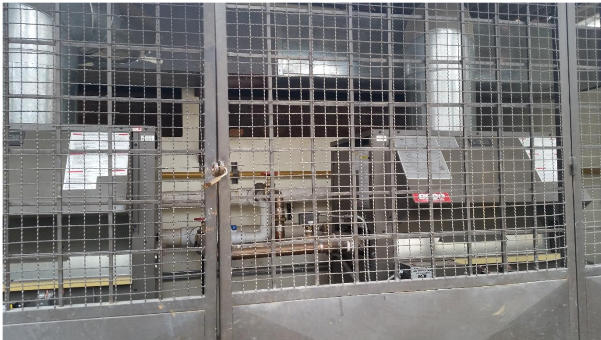
Figura 25. Calderas serie 8900, utilizadas para el área de la piscina y zona húmeda
