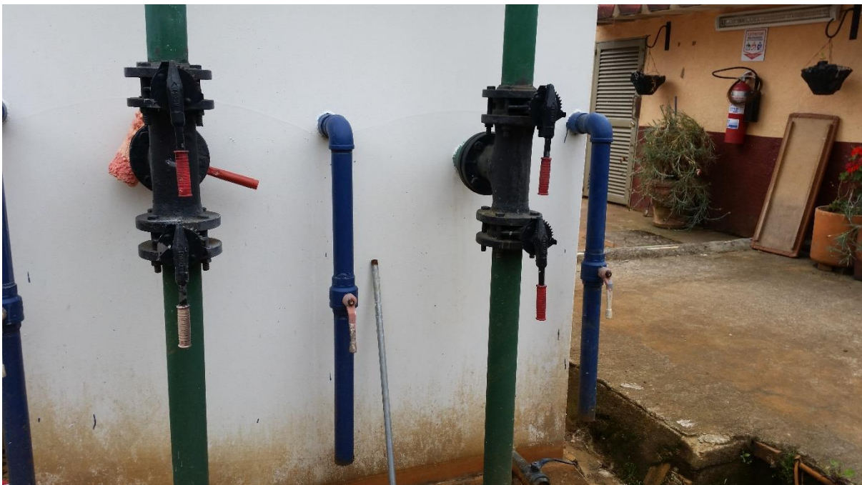
Figura 18. Sistemas de tuberías y válvulas
