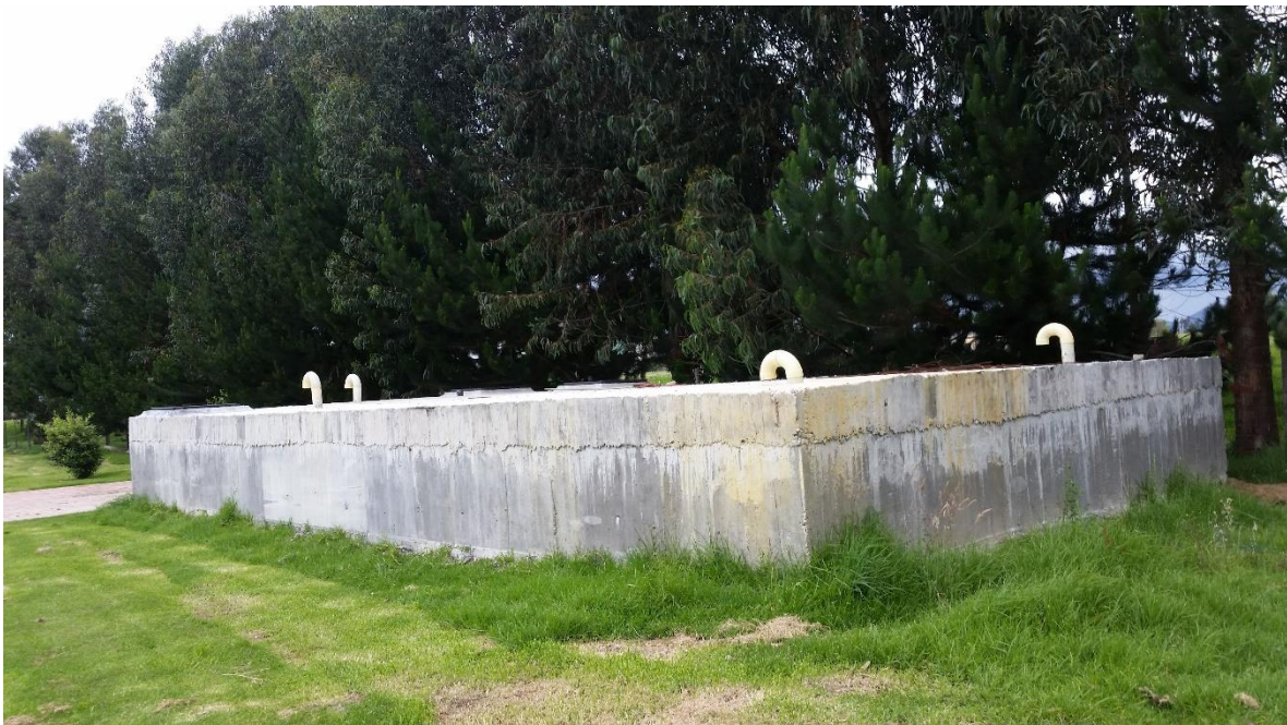
Figura 22. Tanque de almacenamiento de agua potable
