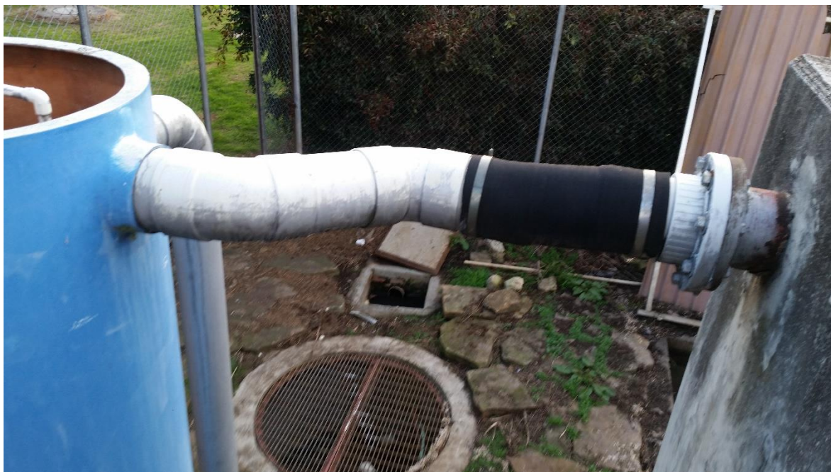
Figura 12. Tanque de almacenamiento de aguas negras
