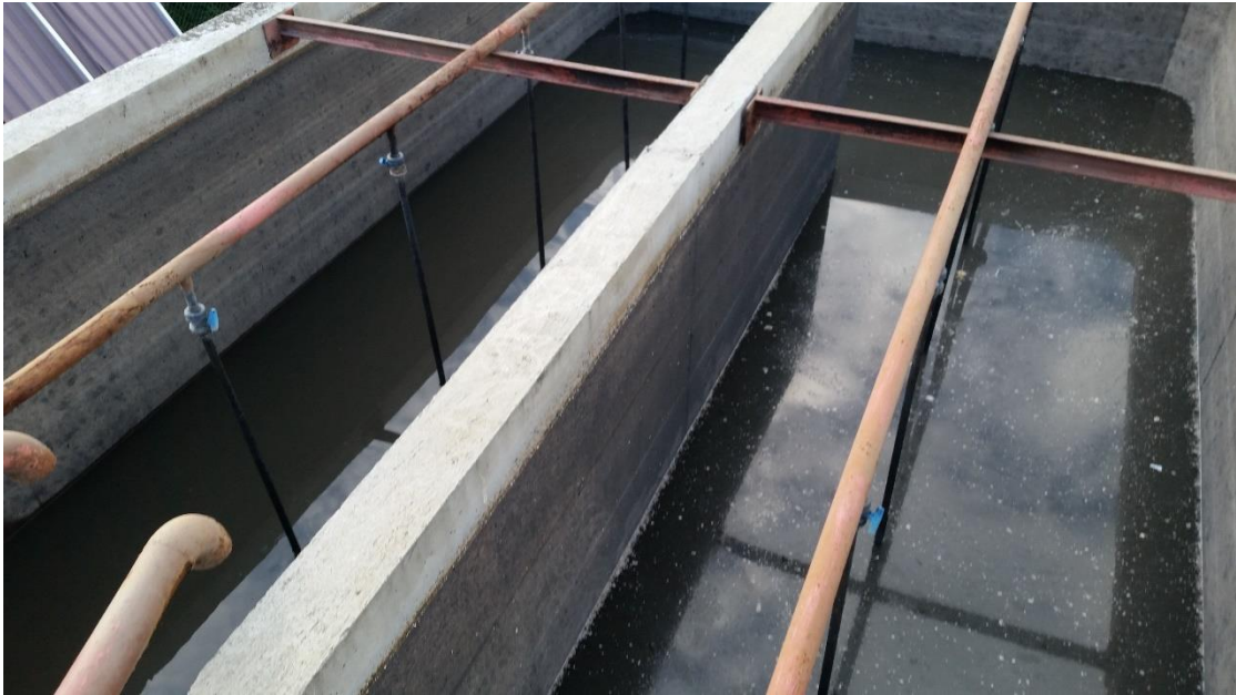
Figura 13. Floculación EDAR clausurada
