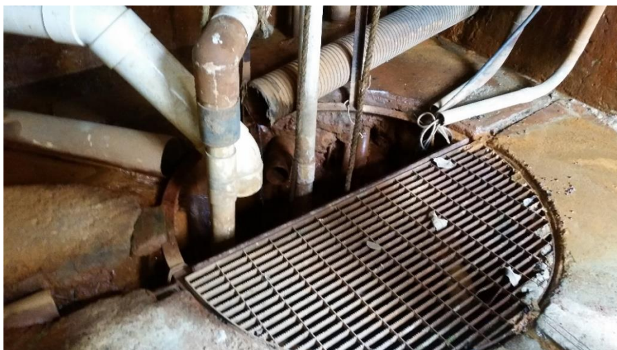
Figura 2. Tubería tanques de contención de agua
