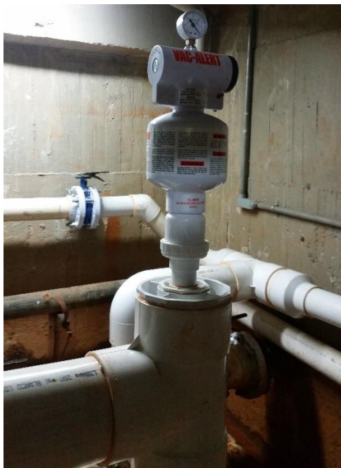
Figura 1. Bomba de agua piscina (maquinaria nueva)
