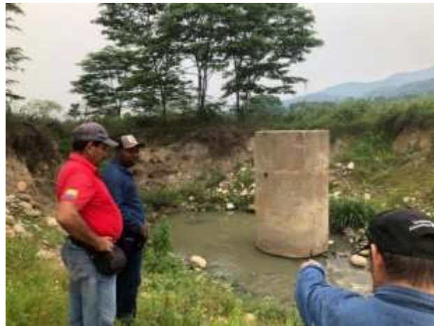
inspección en la rotura de una tubería que esta contaminando Nota. Adaptado des hídricas
