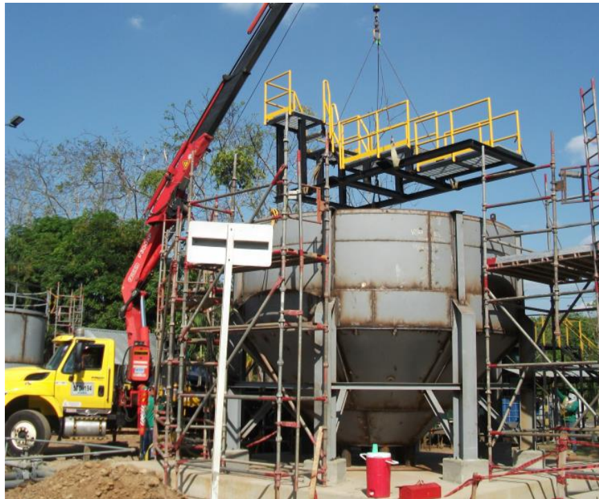
Figura 17. Tanque decantador de lodos.
