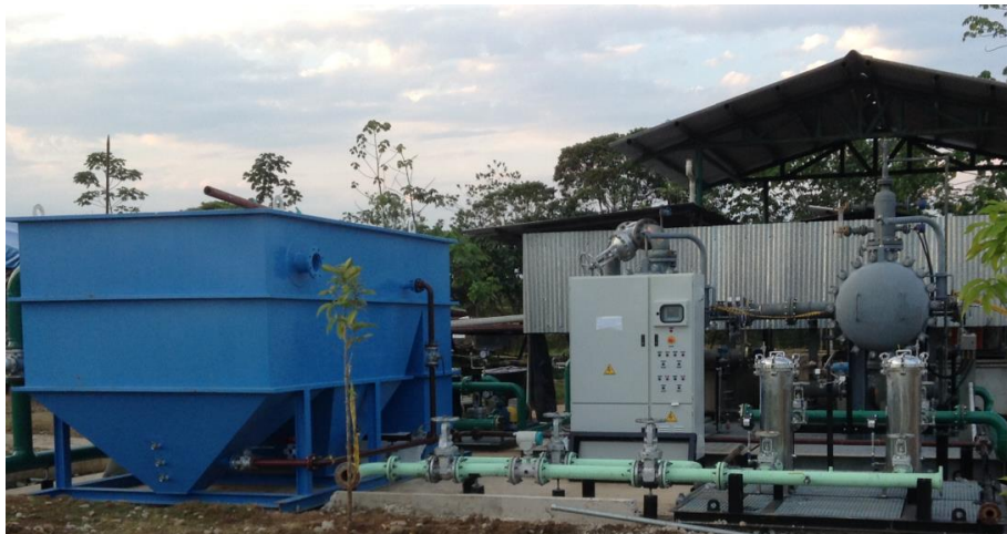
Figura 9. Tanque separador de placas inclinadas.
