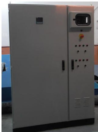
Figura 19. Tablero de control y potencia.
