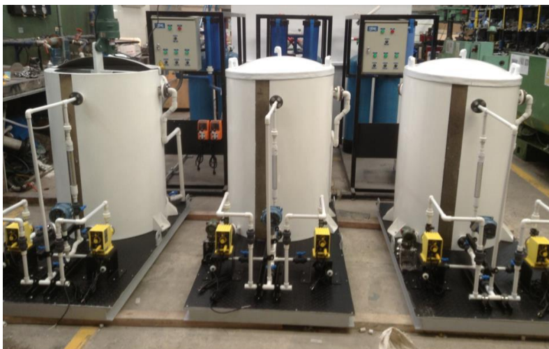
Figura 18. Sistema de dosificación de químicos.
