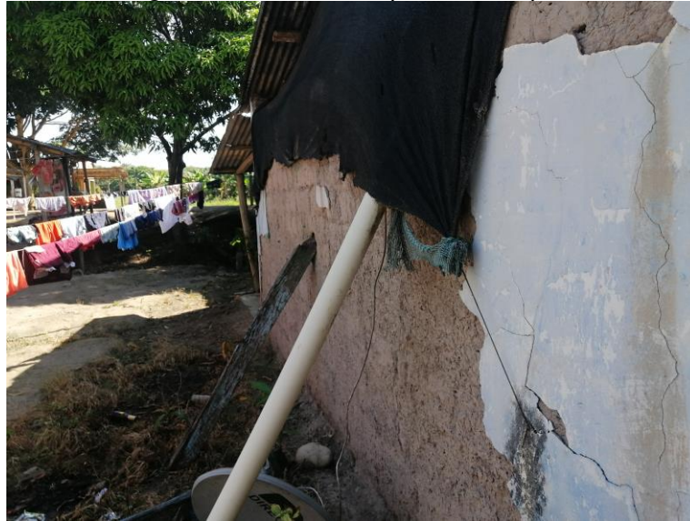
Figura 26. Pared con posible colapso.
