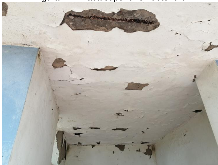
Figura 22. Placa superior en deterioro.
