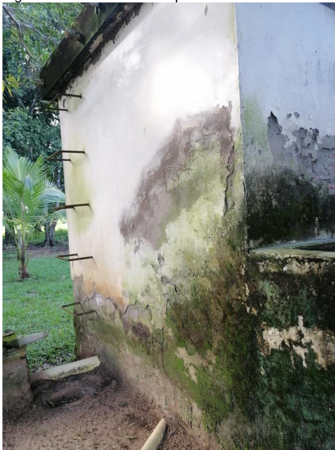
Figura 23. Humedad vista posterior unidad sanitaria.
