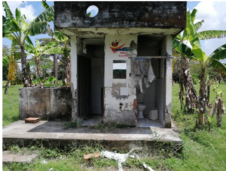
Figura 21. Unidad sanitaria en deterioro.
