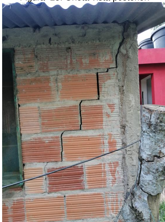
Figura 25. Grieta vista posterior.
