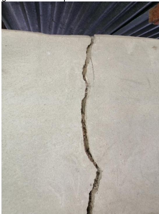
Figura 24. Grieta pronunciada en la vivienda.
