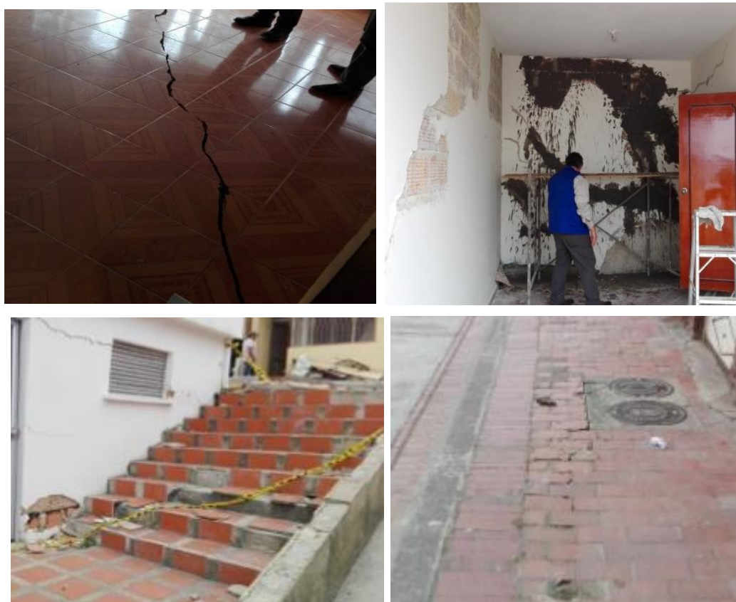
Figura 3. Evidencia fotográfica de los daños presentados en la infraestructura de la zona urbana
