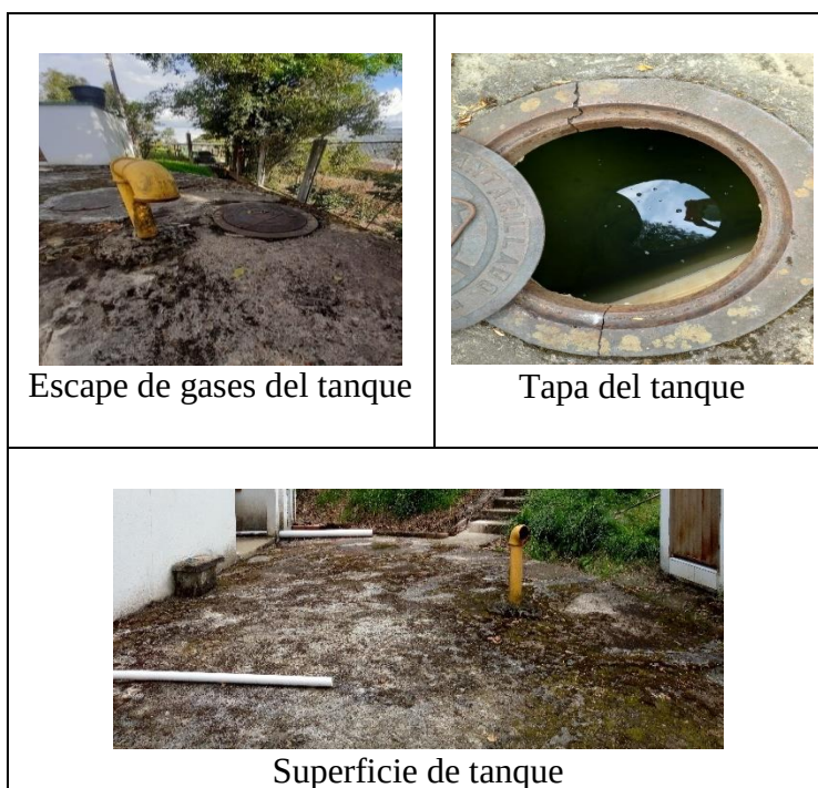
Imagen 15. Tanque de almacenamiento
