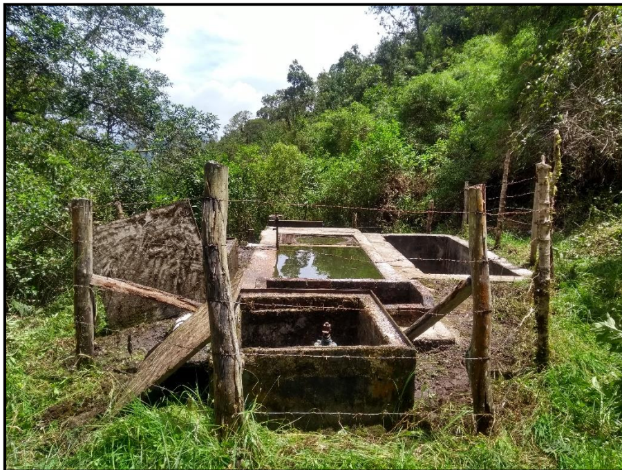
Imagen 1. Vista general del sistema captación.
