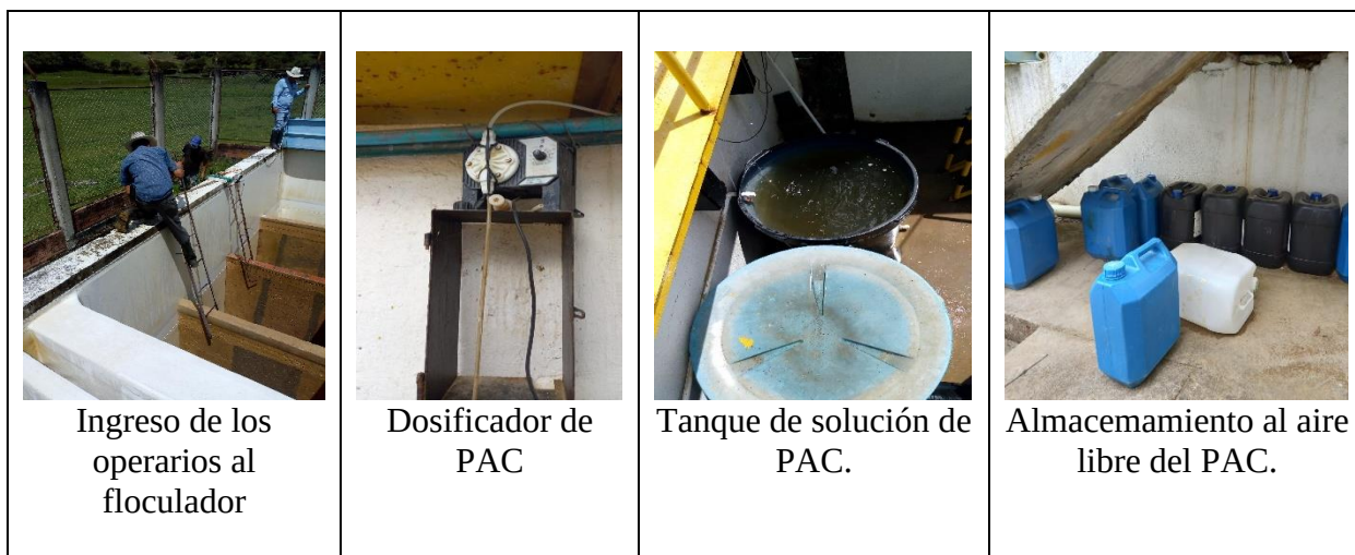
Imagen 11. Complemento proceso de floculación.
