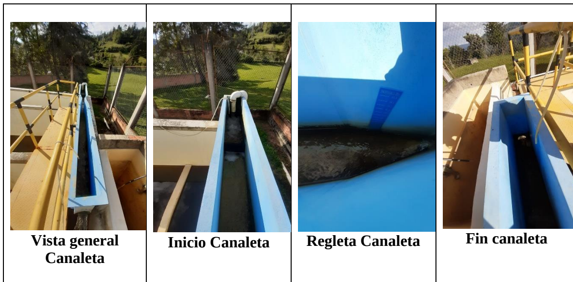
Imagen 8. Canaleta Parshall. Recepción del caudal.
