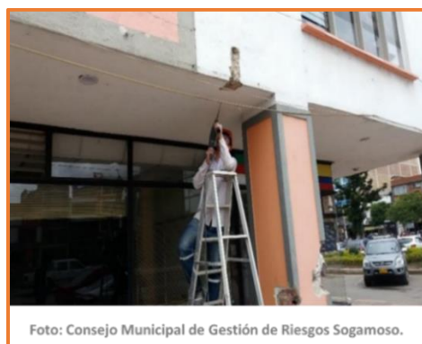
Figura 1: Se evidencia evaluaciones técnicas de sismo resistencia aplicadas al edificio administrativo de Sogamoso. Tomado de http://www.sogamoso-boyaca.gov.co/noticias/edificio-de-la-alcaldia-de-sogamoso-no-paso-evaluacion .
