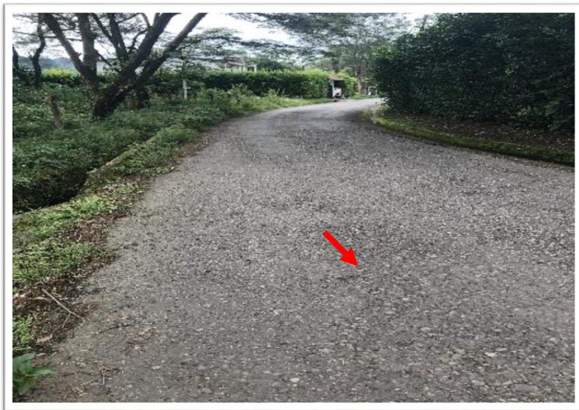
Fotografía 13. Piel de cocodrilo en la vía en estudio. Vereda La Argentina.
