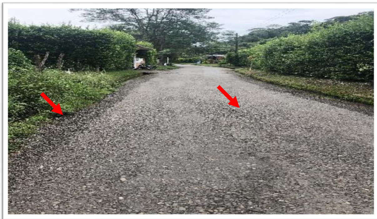
Fotografía 12. Desgaste superficial de la vía en estudio. Vereda La Argentina.
