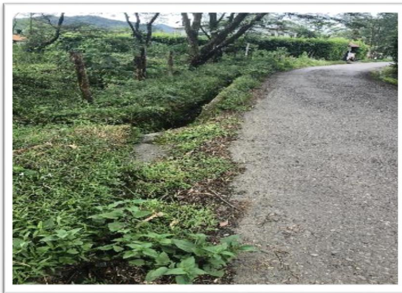
Fotografía 14. Cuneta con sección Hidráulica insuficiente. Vereda La Argentina.
