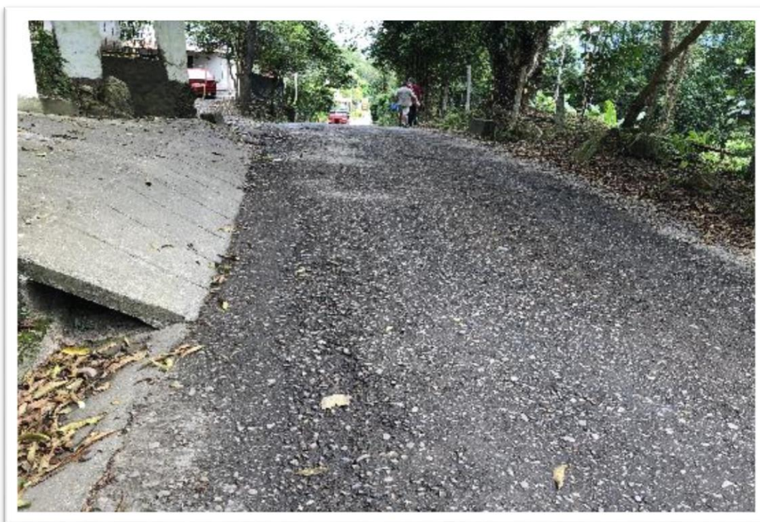
Fotografía 2. Primer recorrido e identificación de lesiones del paciente, ubicadas en el k1+930
