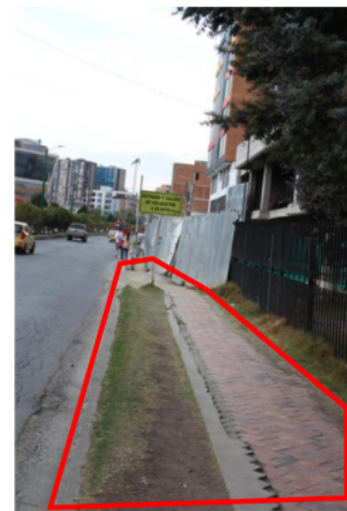
Imagen 10. Análisis fotográfico Andenes desnivelados y con inexistencia de losetas podotáctiles
