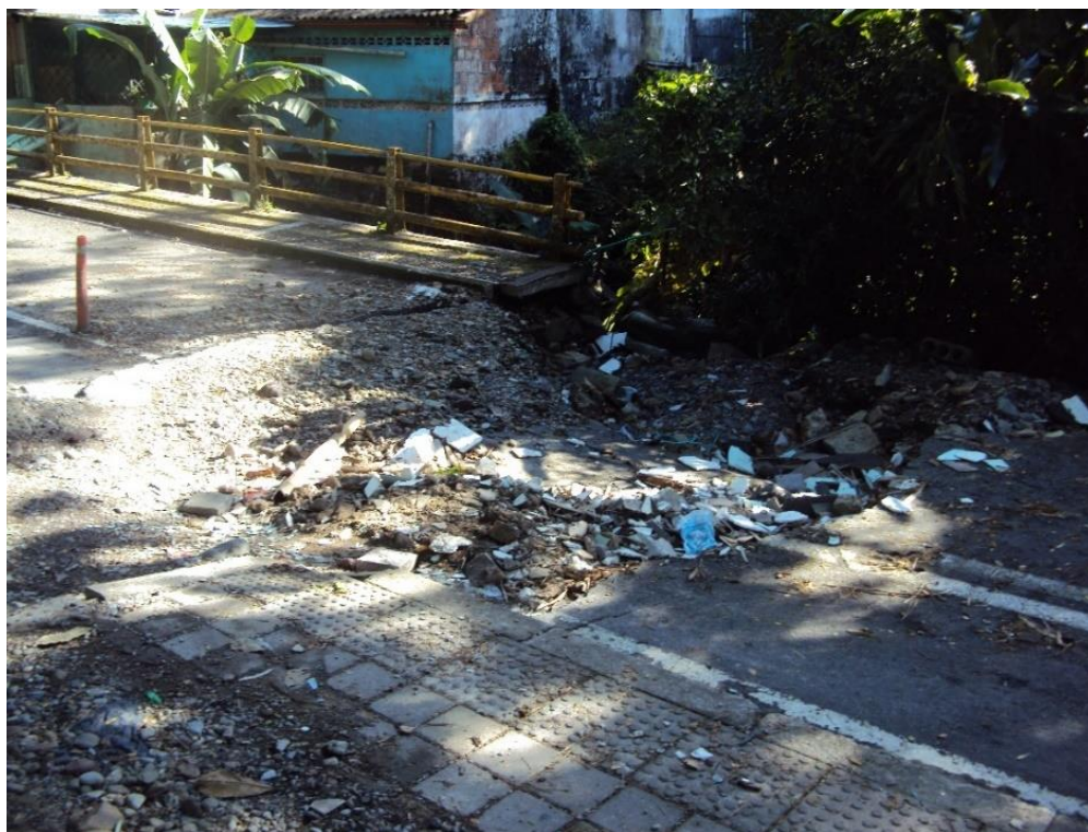
Falla 1. Desprendimiento del material de relleno sobre el estribo del puente
