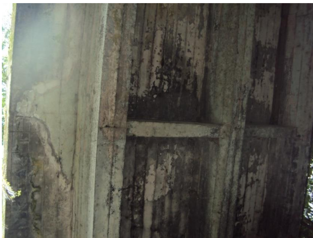
Falla 6. Suciedad en vigas del tablero
