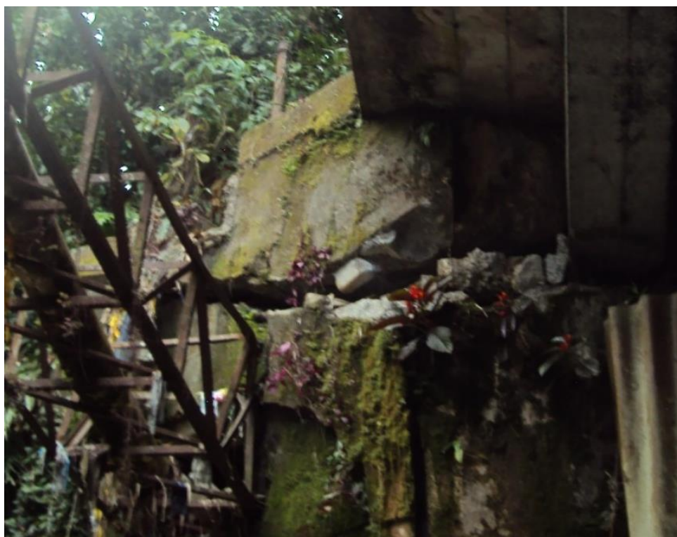
Falla 5. Fatiga y fracturación del estribo
