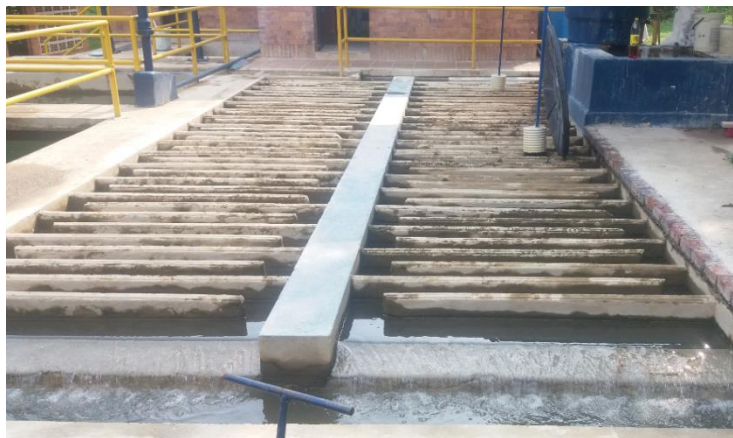
Ilustración 10. Floculador hidráulico de pantallas de flujo horizontal. Fuente: propia
