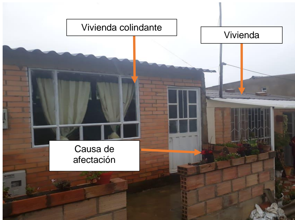
Ilustración 38. Fachada de Vivienda Afectada
