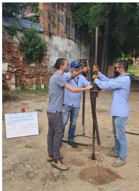
Figura 19: Instalación del equipo. Fuente: Propia
