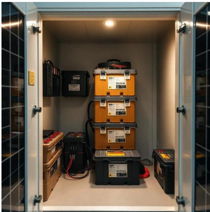
Imagen 15. Batería de almacenamiento de energía
