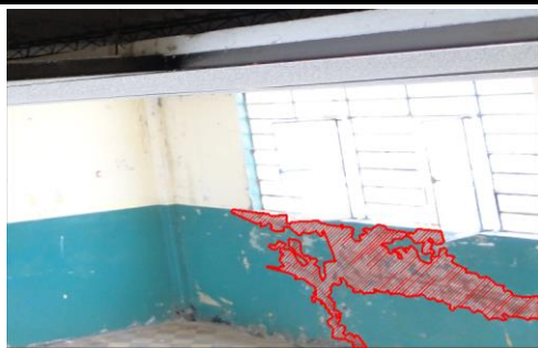
Deformación de cerchas y desprendimientos en muros de fachada. (Vista Interna)
