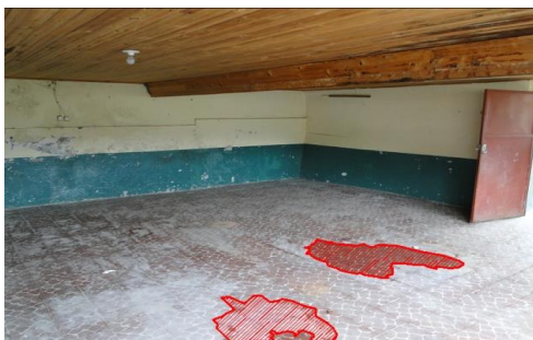
Losa de entrepiso agrietada con aparición de musgos y eflorescencias.
