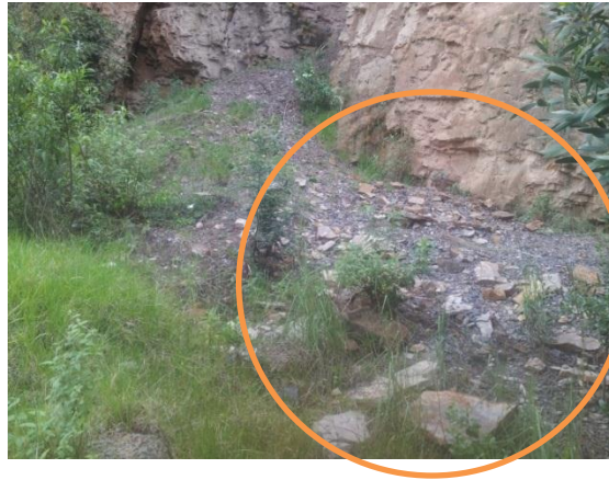
Figura 42. Fenómenos de remoción en masa, caída de bloques en pie del talud (zona 2)
