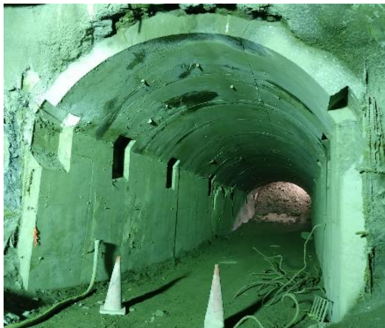
Vista desde aguas arriba (caverna de transformadores)
