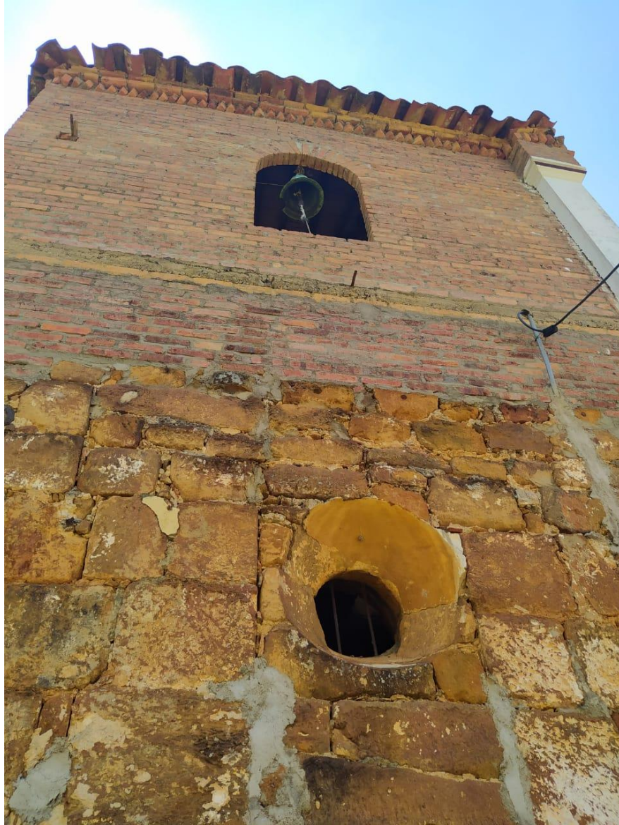
Figura 15. Evidencia de la inadecuada intervención de la torre de la iglesia
