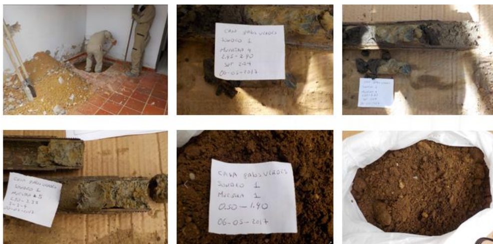
Fotografía 22: Apique 1 y sondeo 1, se evidencia suelos con alto contenido de humedad y altamente deformable, se ubica directamente bajo la viga de cimentación. Fuente propia 2017.
