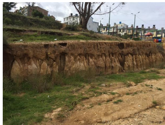
Fotografía 3: Suelos erosionables en la ladera en la cual se ubica el barrio. Fuente propia 2017.
