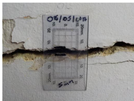
Fotografía 8: Fisura de 5mm que atraviesa el espesor del muro, ver en la ilustración 1 el sitio de toma. Fuente propia 2017.
