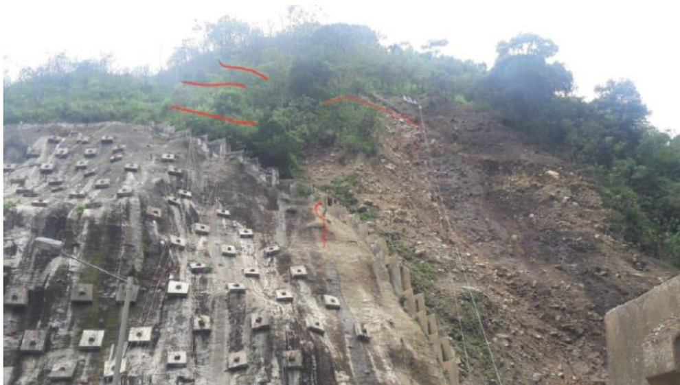
Figura 30. Aparición de grietas importantes arriba del Portal 26
