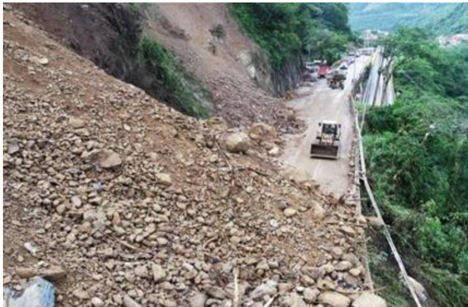
Figura 1. Derrumbe kilómetro 58, vía Bogotá Villavicencio, Municipio de Guayabetal
