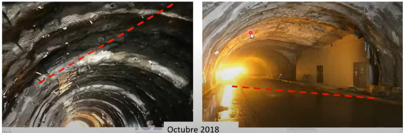
Figura 38. Grietas diagonales con filtración de agua
