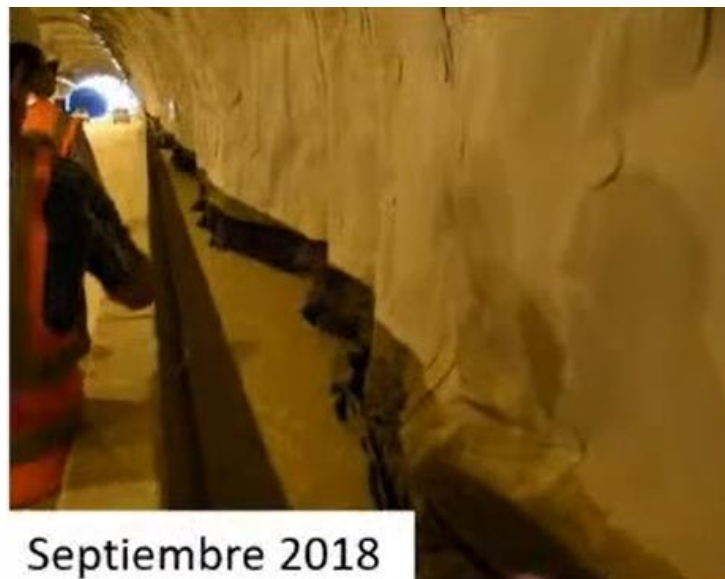
Figura 37. Desplazamiento hastial derecho
