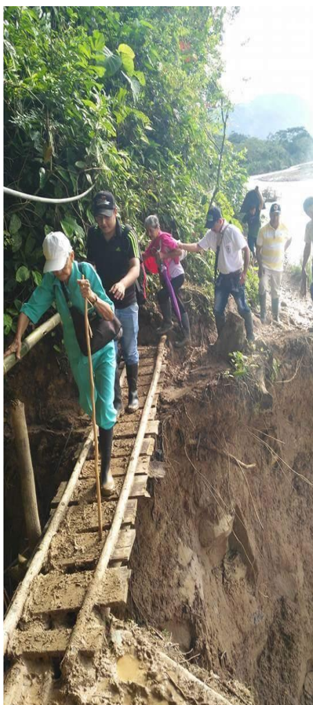
Ilustración 41: Pérdida de La Banca Vía San Luis Santa Teresa 1
