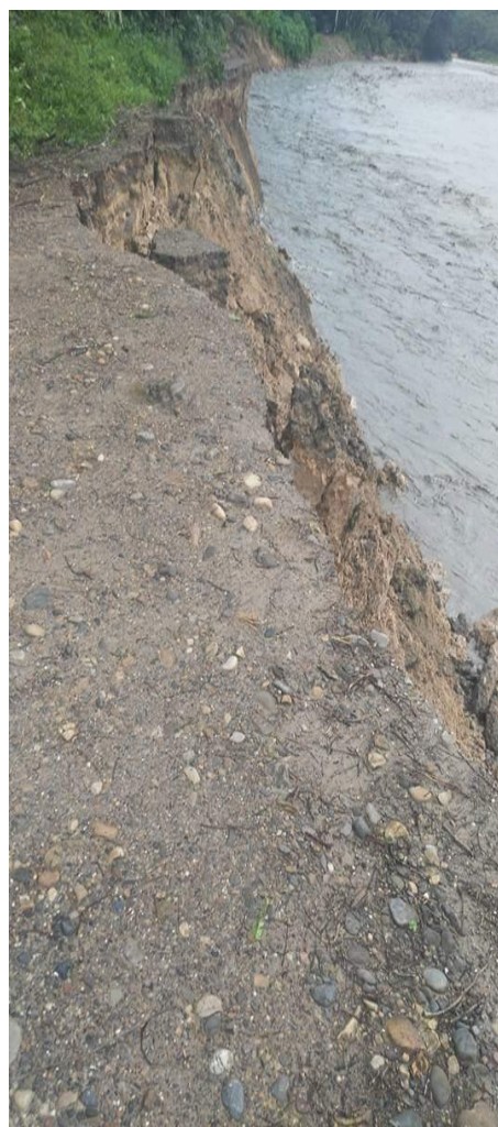
Ilustración 42: Pérdida de La Banca Vía San Luis Santa Teresa 2
