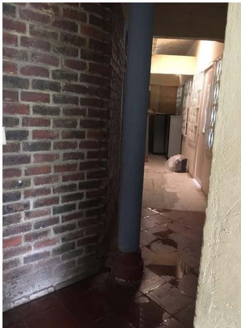
Ilustración 6: Patología Vigas y Columnas 2
