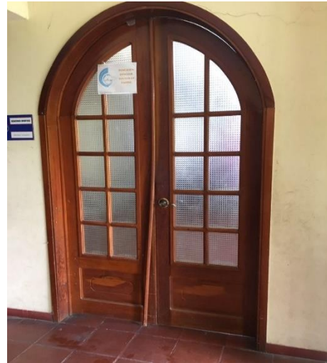
Ilustración 8: Patología Vigas y Columnas 4
