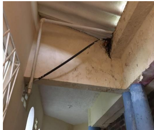
Ilustración 5: Patología Vigas y Columnas 1
