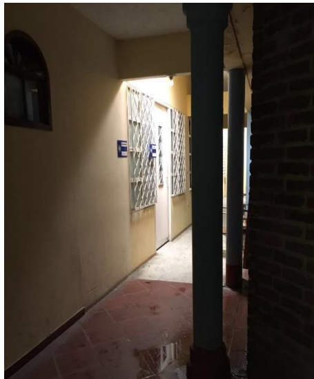
Ilustración 9: Patología Vigas y Columnas 5
