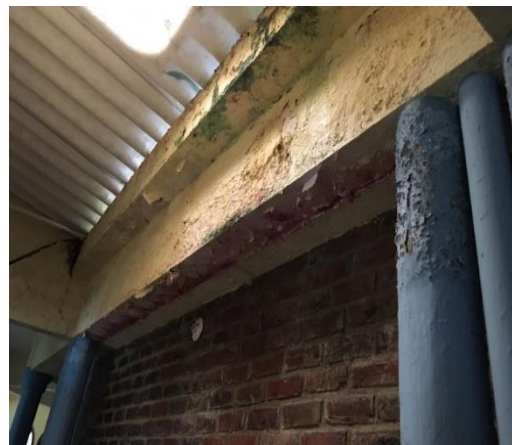
Ilustración 7: Patología Vigas y Columnas 3
