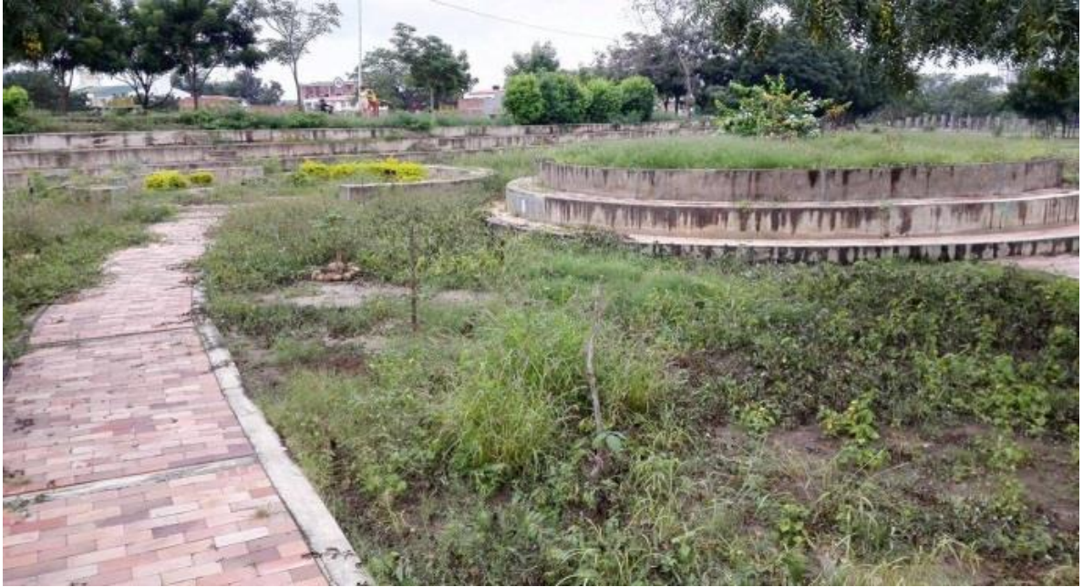
Figura 2. Estado actual de senderos peatonales
