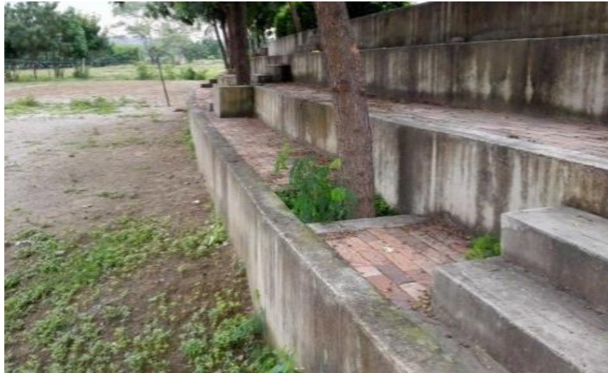
Figura 4. Estado actual de las gradas de la cancha de fútbol
