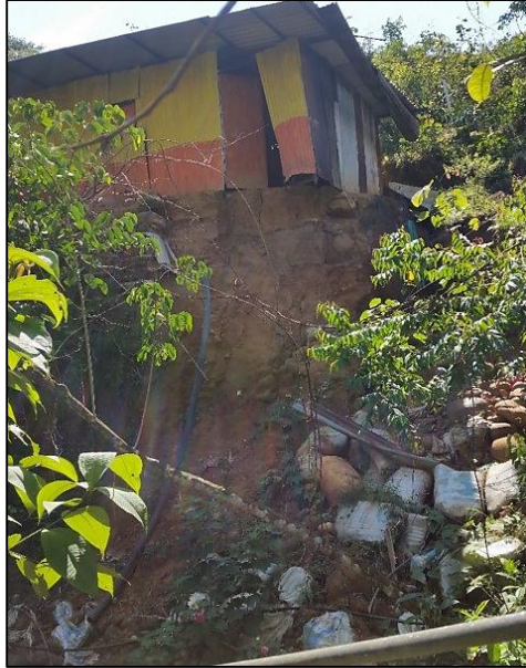
Figura 4-3 Proceso de remoción en la base de una vivienda. Fuente: Propia
