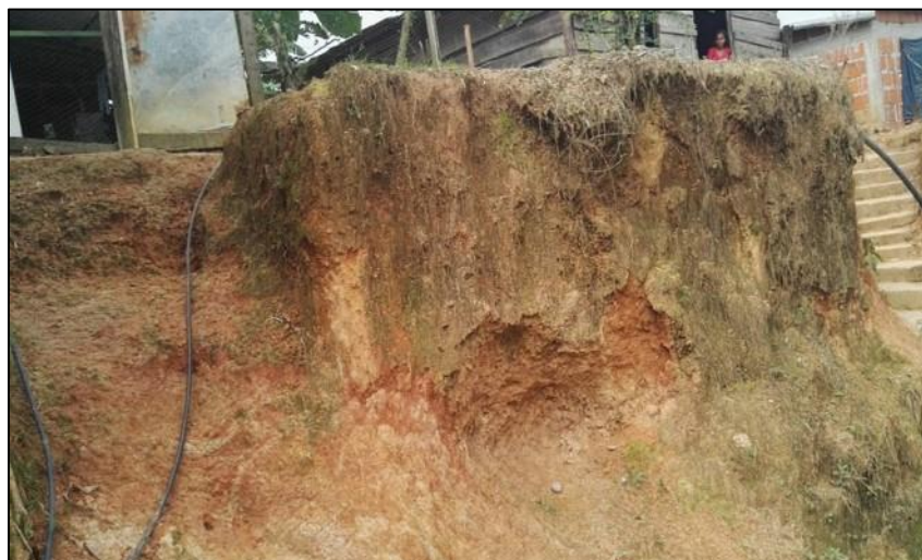
Figura 4-5 Talud artificial vertical socavado. Fuente: Propia
