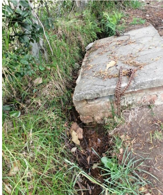
Fotografía 3. Bocatoma Sector la Escuela.
