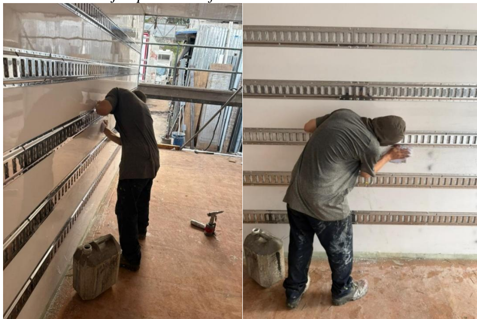
Figura 1. Puesto de trabajo operario de fibra
