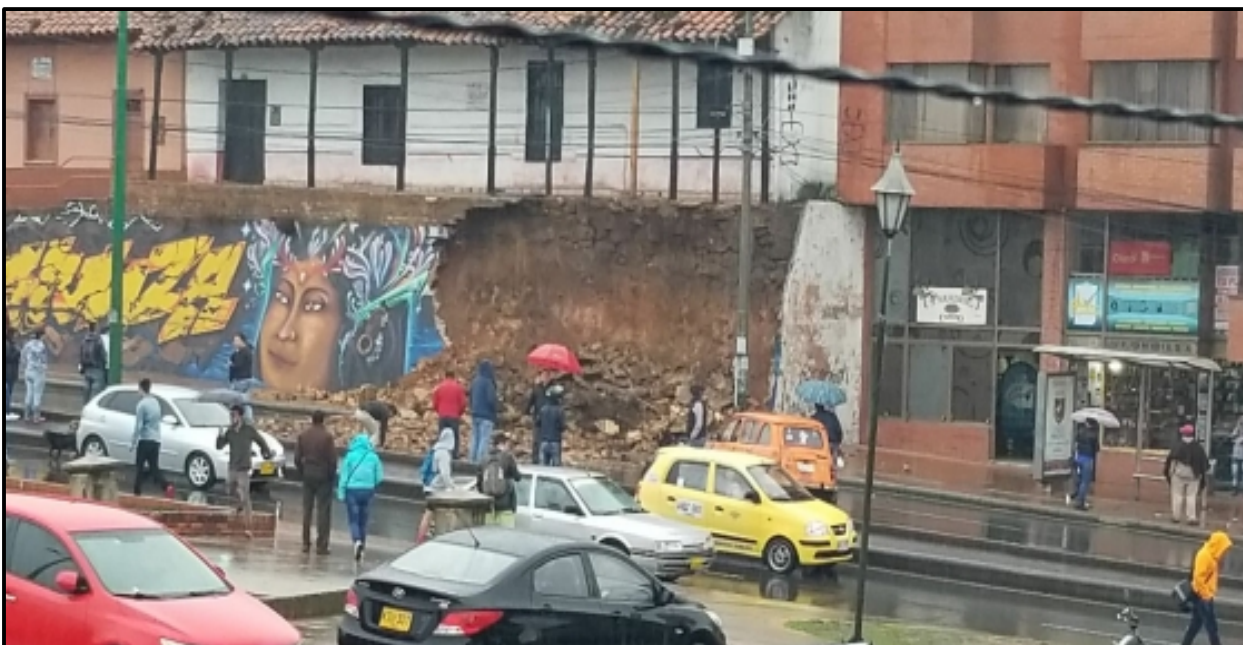
Ilustración 3. Muro barrio las nieves (desplome)
