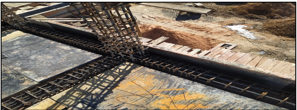
Figura 13. Viga aérea 3 – Torre B - Bloque 2, Torres del parque [FOTO]. Fuente: Elaboración propia, 2019.
