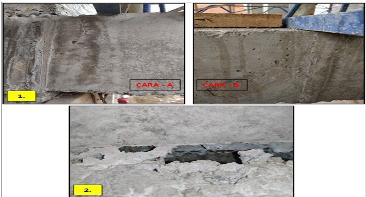
Figura 30. Patologías en elementos estructurales, multifamiliar Torres del parque [FOTO]. Fuente: Elaboración propia, 2019.
