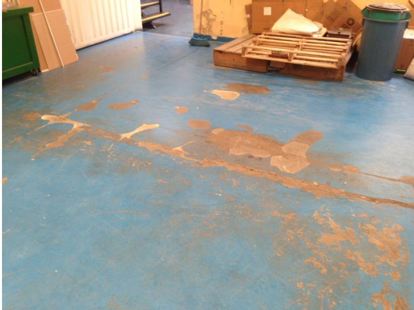
Piso de bodega en mal estado
