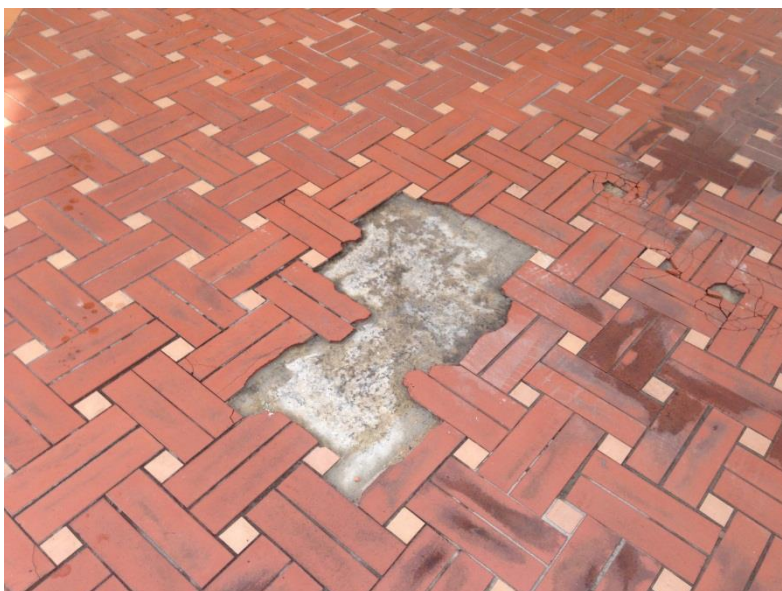
Piso del garaje agrietado
