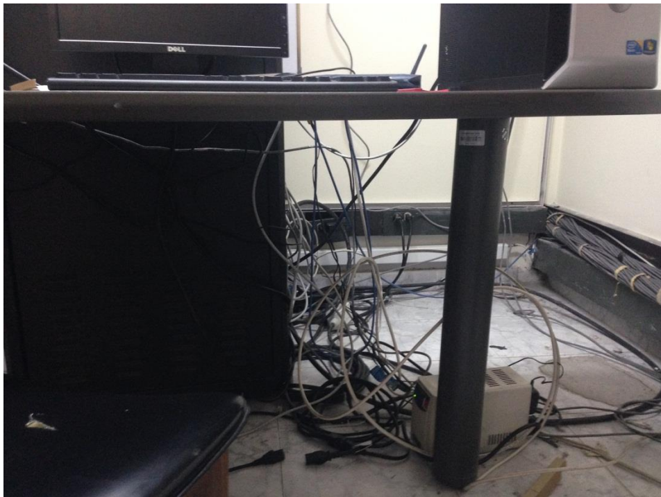
Cables sueltos sin canalizar
