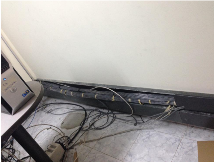
Cables sueltos fuera del canal
