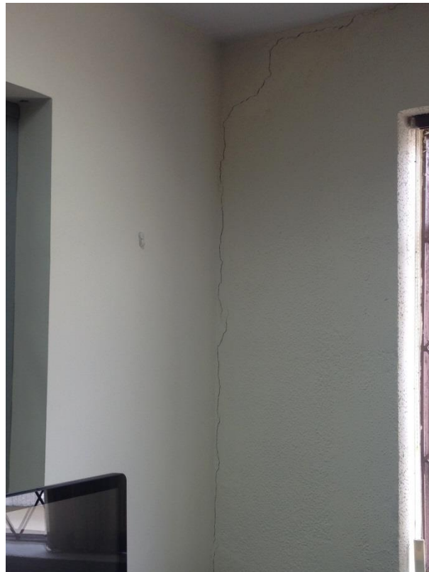
Pared agrietada en oficina
