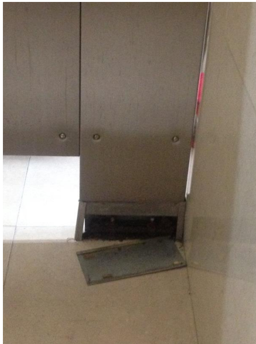
Puerta del baño mujeres edificio B primer piso
