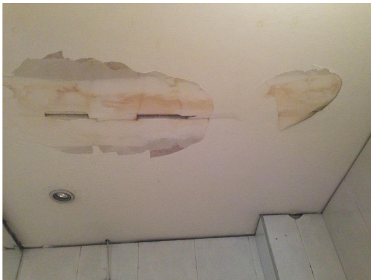
Humedad en el techo último piso
