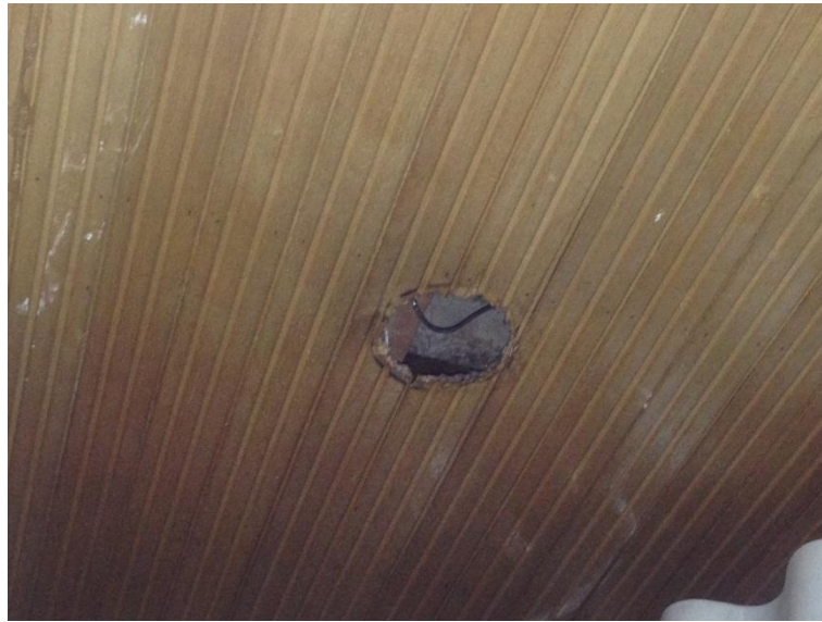
Hueco en techo de madera
