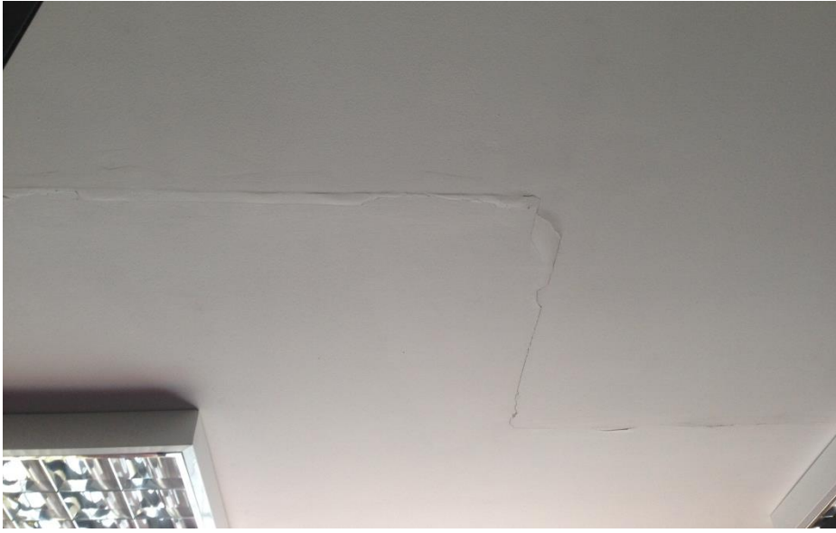
Grietas techo sexto piso
