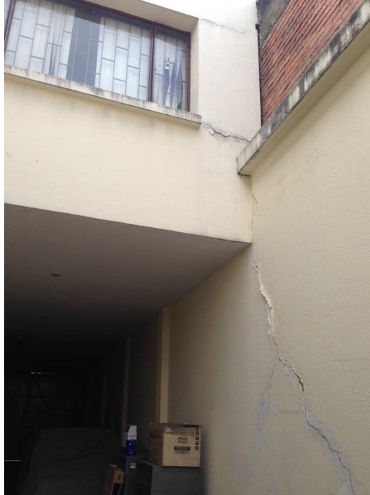
Pared de la bodega agrietada
