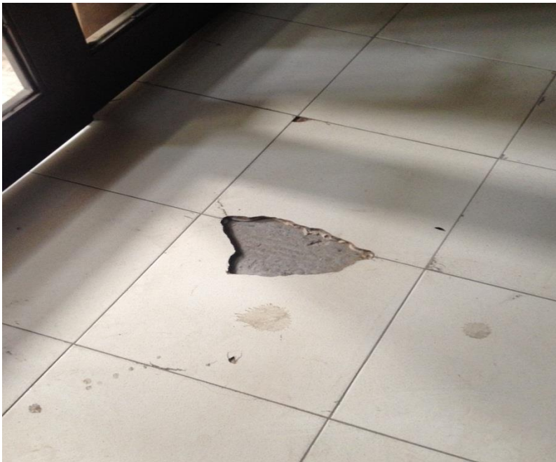
Baldosa rota en piso del primer piso de opción vida
