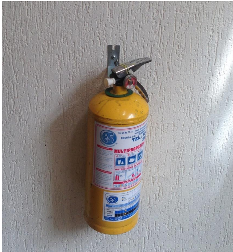
Extintor sin señalizar
