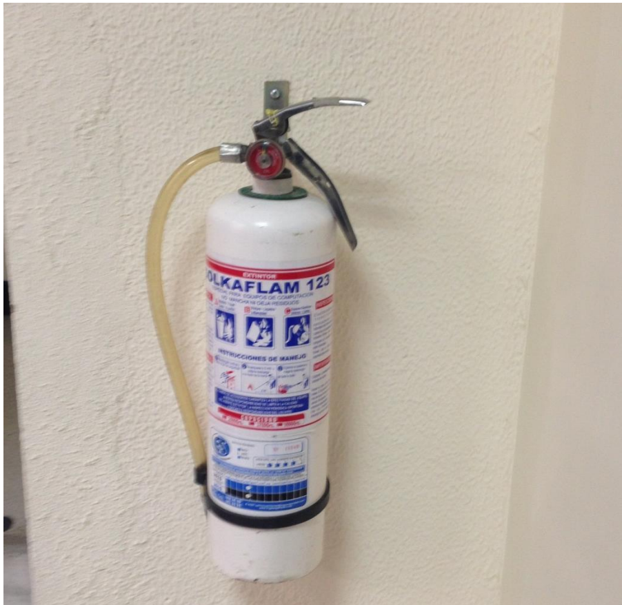
Extintor sin señalizar
