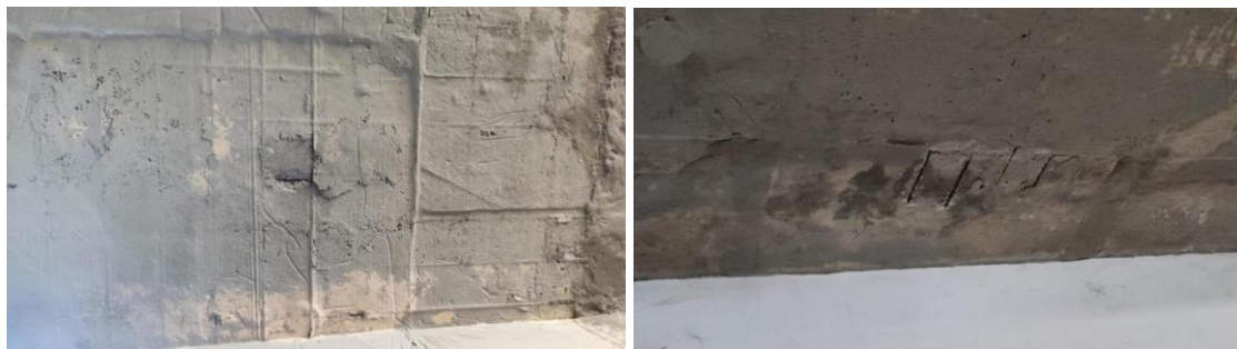
Fotografías 9 y 10. Acero expuesto con bajo recubrimiento y sujeto a corrosión.
