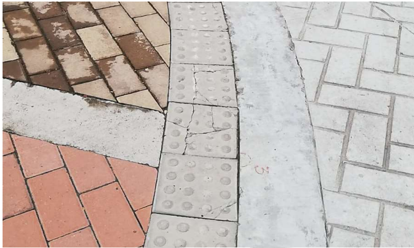
Imagen 1. Fractura de loseta toperol A-55, K0+290 calzada izquierda.
