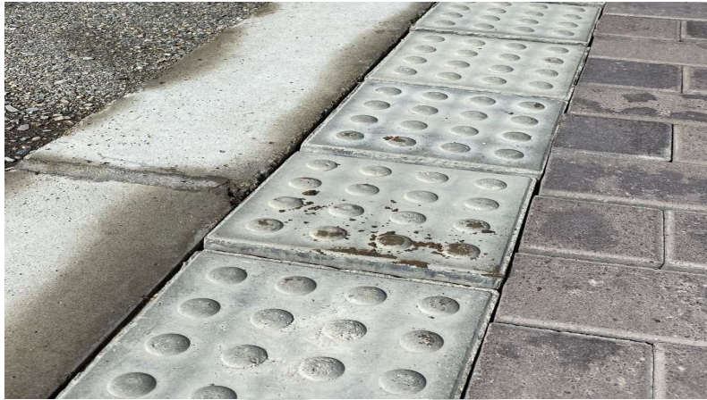
Imagen 4. Levantamiento de loseta toperol A-55 debido a altas precipitaciones, K1+610 calzada derecha.
