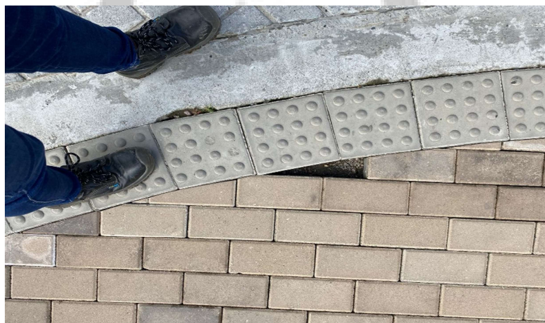
Imagen 9. Levantamiento de adoquín debido a altas precipitaciones y falta de instalación del sello de arena, K1+730 calzada derecha.
