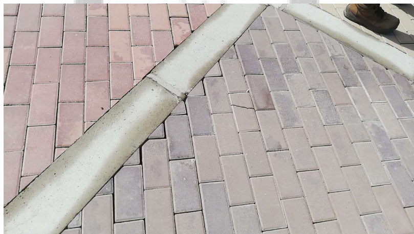
Imagen 3. Levantamiento de adoquín debido a altas precipitaciones y falta de instalación del sello de arena, K1+600 calzada derecha.
