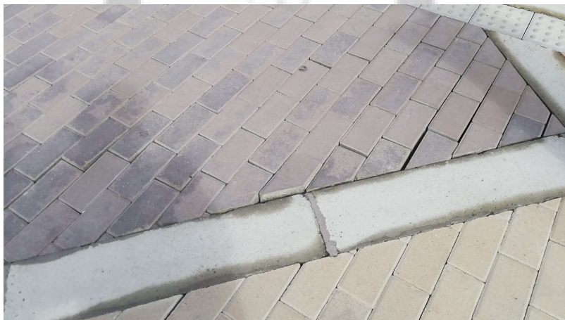
Imagen 6. Levantamiento de adoquín debido a altas precipitaciones y falta de instalación del sello de arena, K1+620 calzada derecha.
