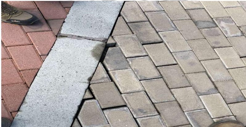
Imagen 8. Levantamiento de adoquín debido a altas precipitaciones y falta de instalación del sello de arena, K1+680 calzada derecha.
