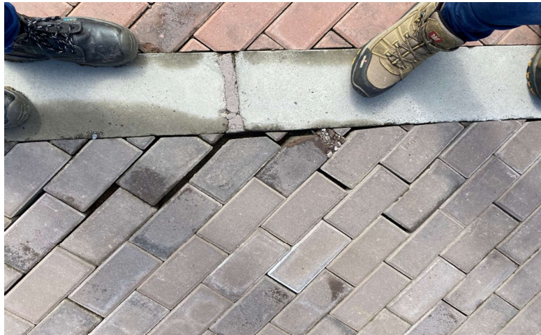
Imagen 10. Levantamiento de adoquín debido a altas precipitaciones y falta de instalación del sello de arena, K1+735 calzada derecha.
