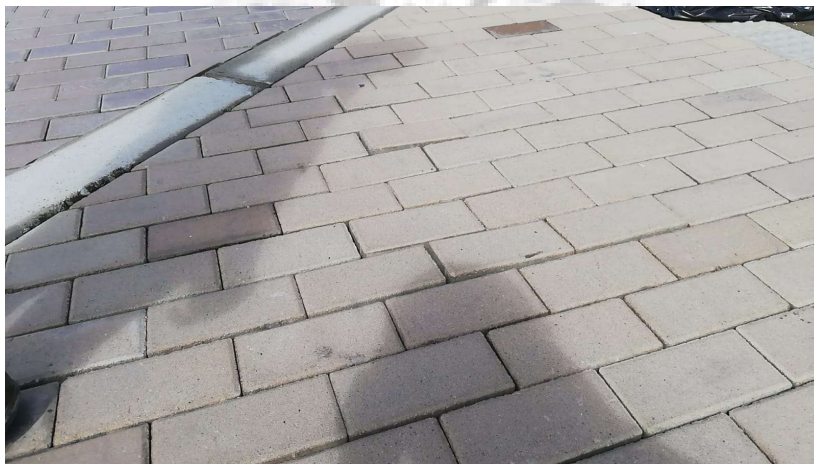
Imagen 2. Levantamiento de adoquín de arcilla debido a altas precipitaciones y falta de instalación del sello de arena, K1+585 calzada derecha.
