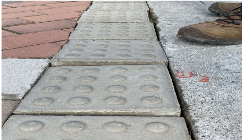
Imagen 7. Levantamiento de loseta toperol A-55 debido a altas precipitaciones, K1+625 calzada derecha.
