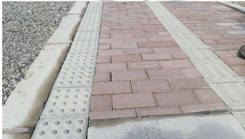
Imagen 5. Levantamiento de adoquín debido a altas precipitaciones y falta de instalación del sello de arena, K1+610 calzada derecha.
