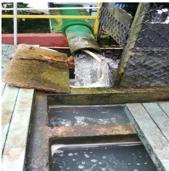
Figura 7 Ingreso a planta de tratamiento
