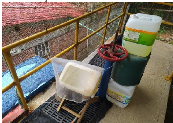
Figura 8 Equipo de cloración del municipio el Castillo
