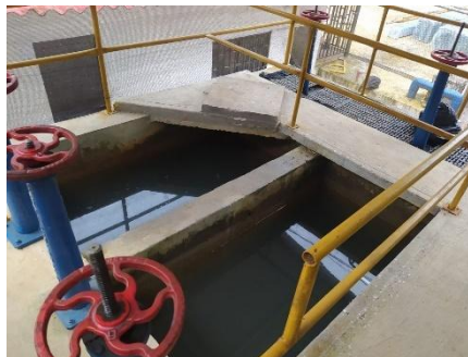
Figura 6 Instalaciones del acueducto del Castillo Meta.
