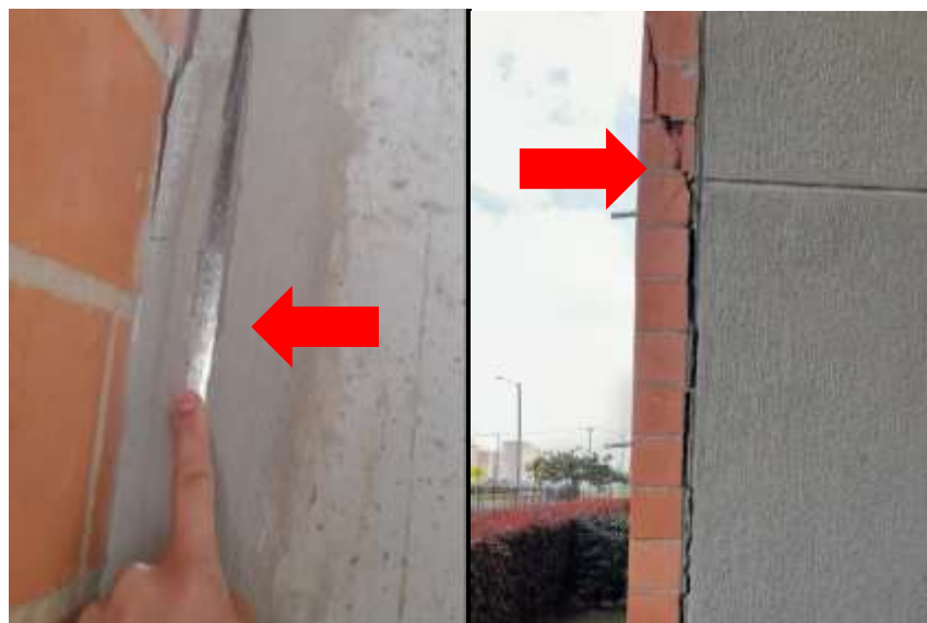
Imagen N°7 y 8– Lesión #3 – Desprendimiento de muro
