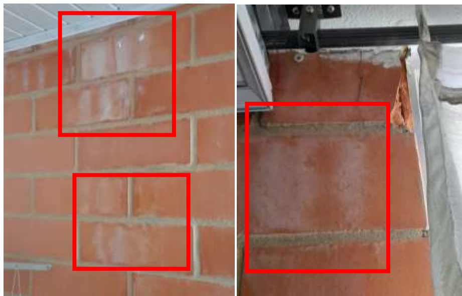
Imagen N°3 y 4– Lesión #1, humedades y eflorescencias
