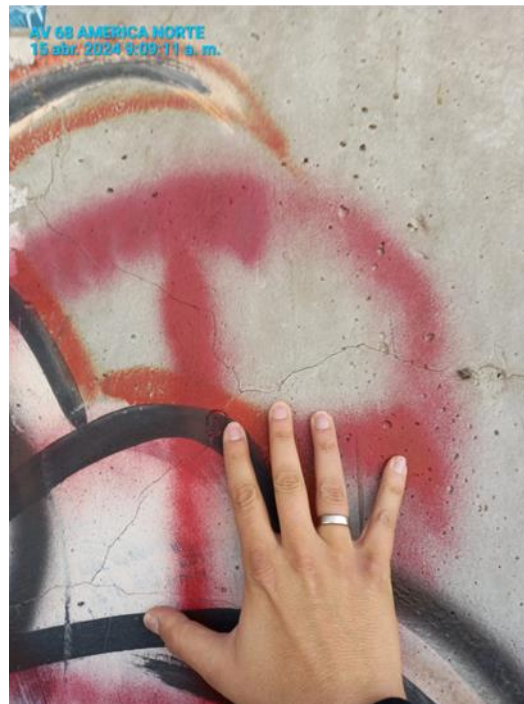
Figura 30: Fisuras por retracción
