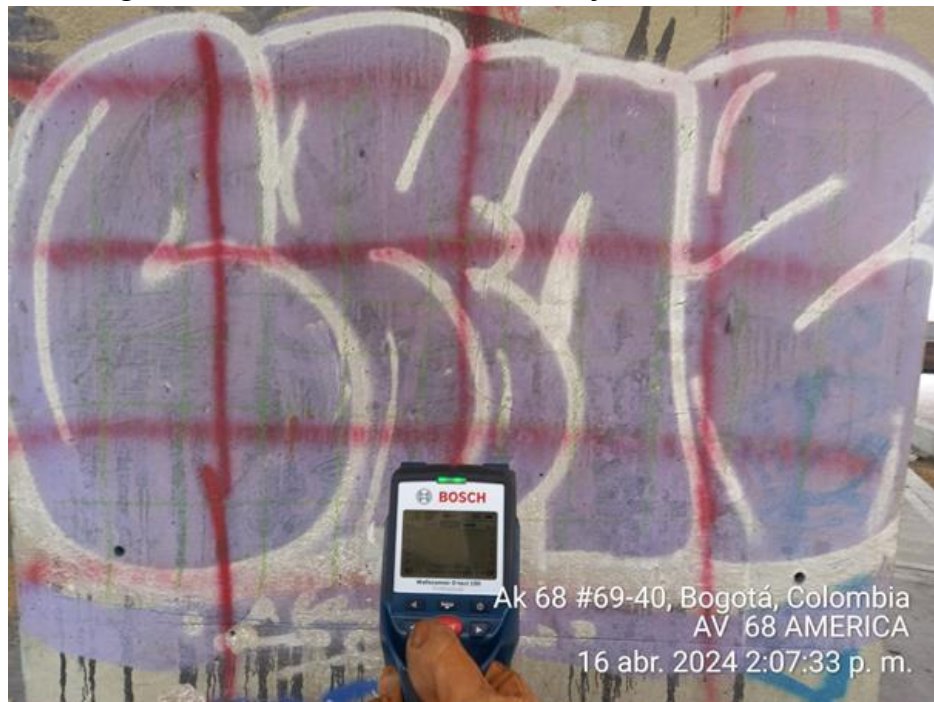
Figura 39: Ferroskan Columna 2 – Eje 4, Costado Norte
