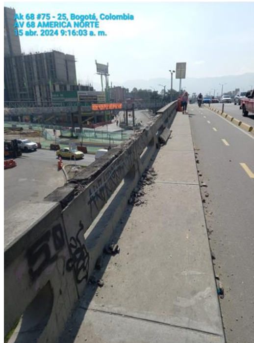
Figura 31: Desprendimiento de corta goteras por impacto vial
