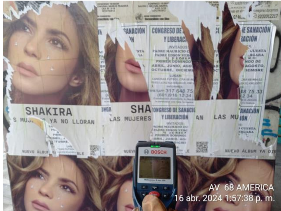
Figura 42: Ferroskan Columna 3 – Eje 4, Costado Sur
