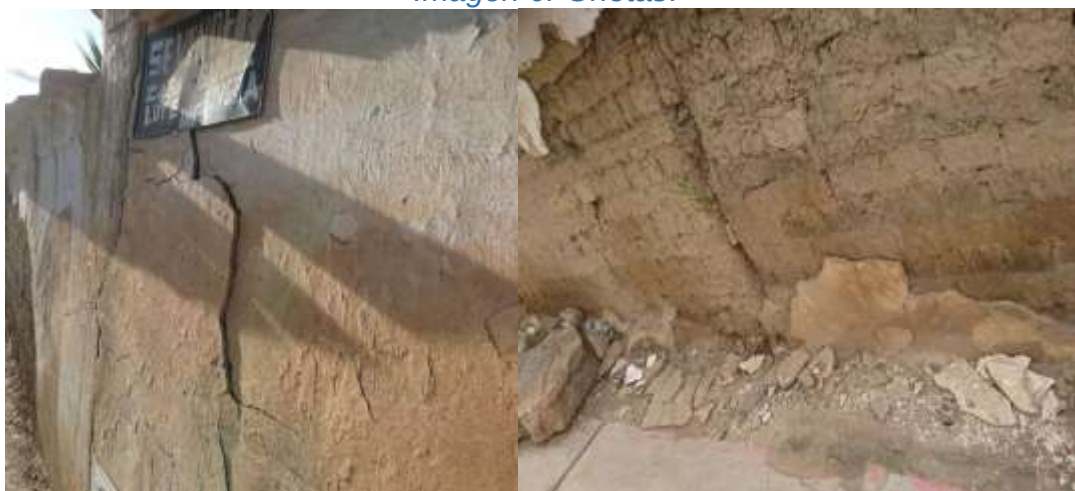
En la imagen 6. Grietas presentes en los muros de cerramiento del predio. FUENTE: autor
