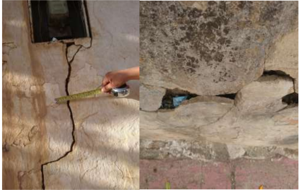
En la imagen 7. Dimensión de las grietas en los muros de cerramientos FUENTE: autor
