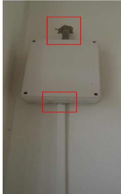
Ilustración 20. Instalación no permitida
