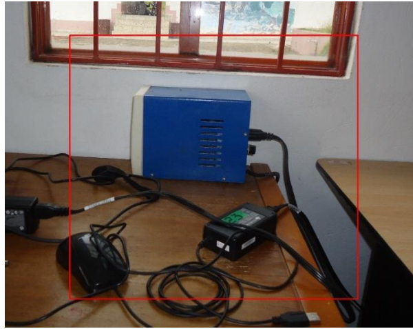
Ilustración 23. Instalaciones eléctricas mal instaladas
