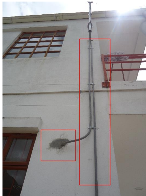
Ilustración 25. Rutas de distribución mal instaladas
