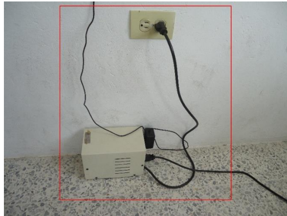
Ilustración 24. Instalaciones eléctricas mal instaladas2
