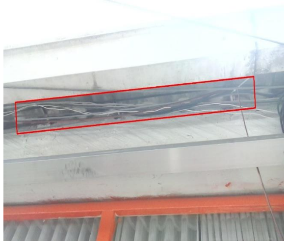
Ilustración 37. Cableado con sumideros
