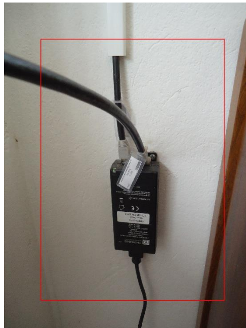
Ilustración 21. Cableado sin protección
