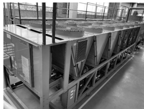
Figura 28. Chiller York 200TR.
