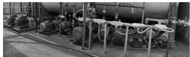
Figura 31. Bombas de descarga hacia procesos.
