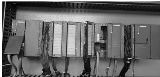
Figura 11. PLC Siemens S7-300 Instalado en campo.
