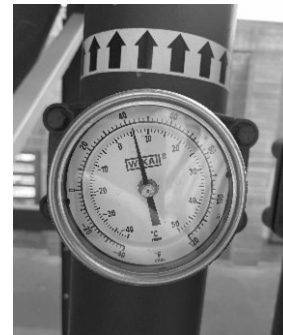
Figura 36. Termómetro a la salida de agua fría chiller 200TR.
