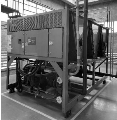
Figura 29. Chiller York 100TR.
