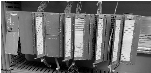
Figura 38. PLC compact SIEMENS instalado en campo.
