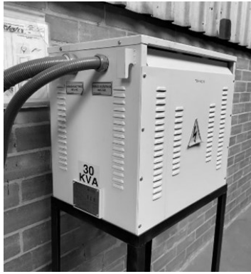
Figura 41. Transformador de 30KVA.
