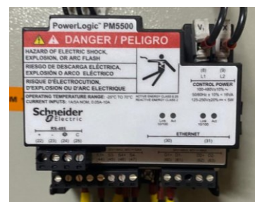
Figura 25. Analizador de red PM5500 instalado en tablero de distribución.
