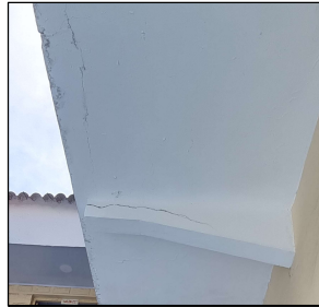
20. Grietas en losa y viga aerea.
