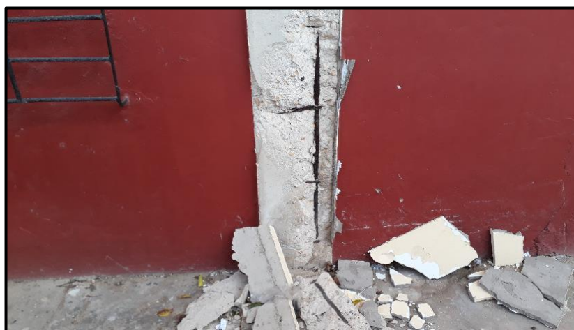
Figura 5. Pérdida del recubrimiento y corrosión del acero de la columna.
