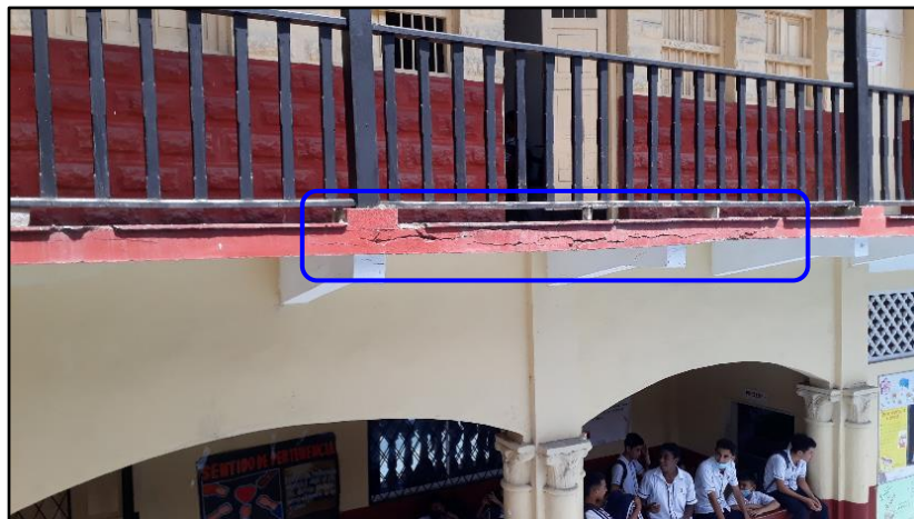
Figura 7. Grietas y desprendimiento de concreto en losa del primer piso.
