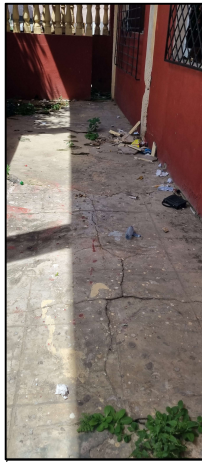
27. Grietas en los pisos exteriores.
