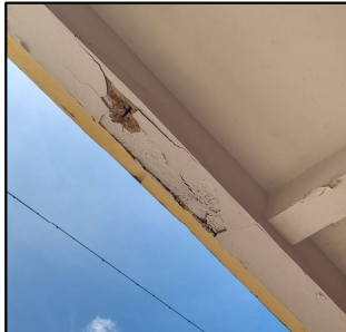
18. Desprendimiento, corrosión en
