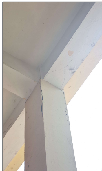
26. Grietas en columna y viga.
