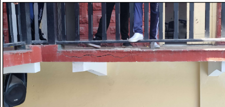
22. Grietas en losa de entrepiso.
