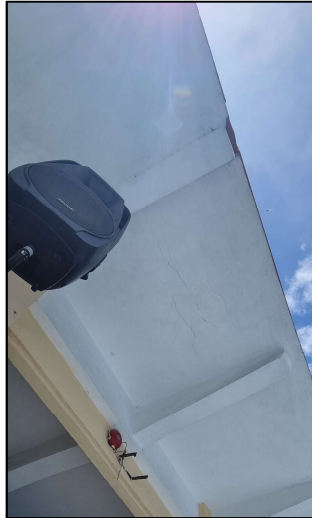
21. Grietas en losa de entrepiso.
