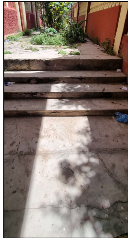
28. Grietas en pisos
