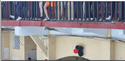
16. Desprendimiento, corrosión en el acero.
