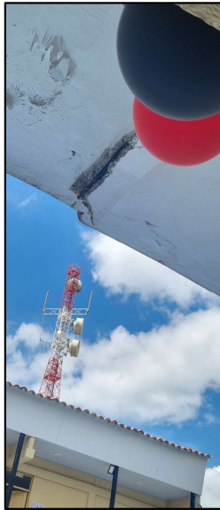
14. Desprendimiento, Corrosión en el acero.
