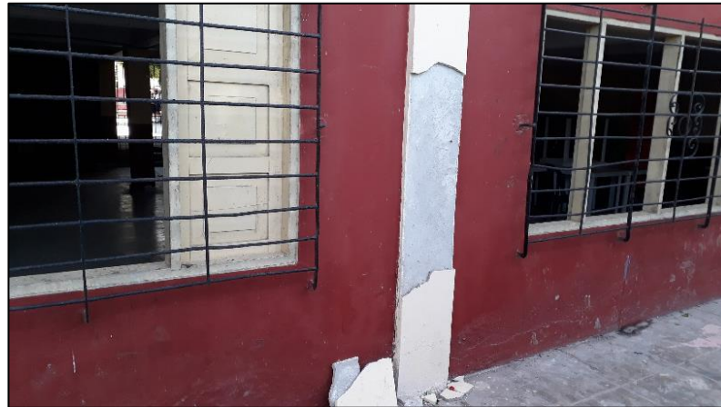
Figura 3. Desprendimiento de pañete parte exterior en columnas de primer piso.
