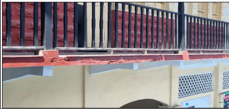
23. Grietas en losa y viga aérea
