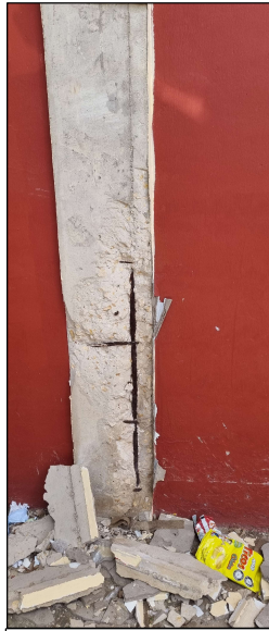
17. Desprendimiento, Corrosión en el acero.
