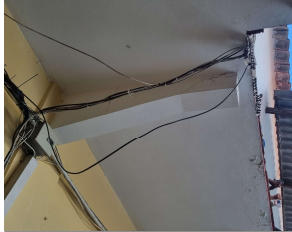
19. Grietas en viga aerea.
