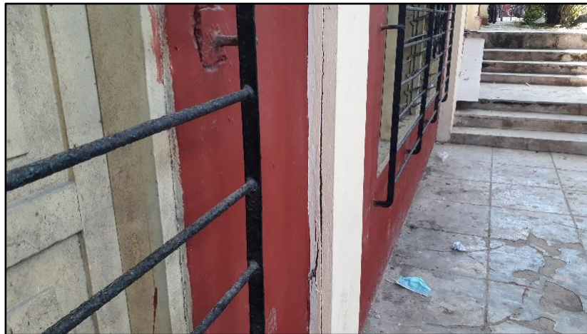
Figura 4. Agrietamiento del concreto en columnas del primer piso.
