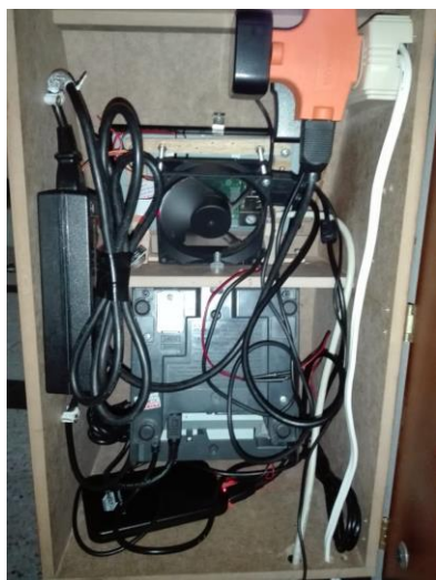
Figura 76. Dispensador de turnos desde el interior. Fuente: Elaboración propia
