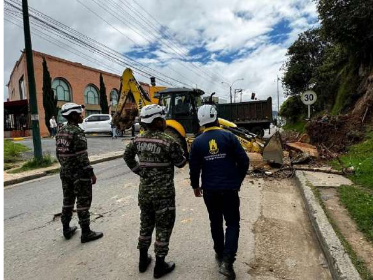
Figura 19. Atención por riesgo de caída de talud en el sector La María
