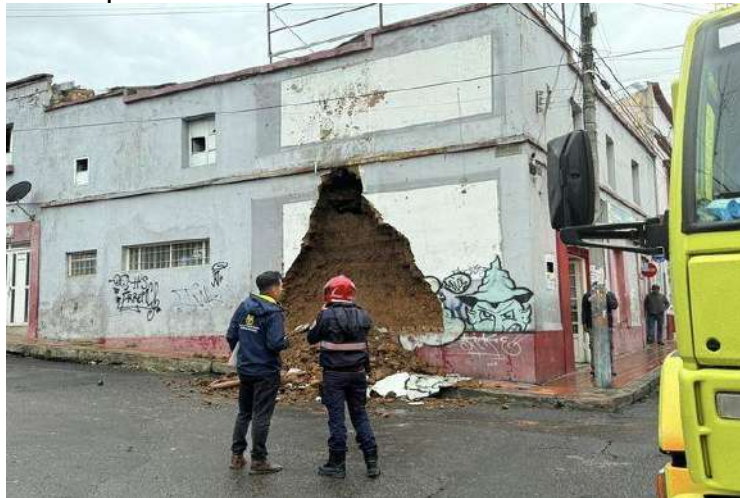
Figura 12. Inspección caída de muro en la calle 23 con carrera 12
