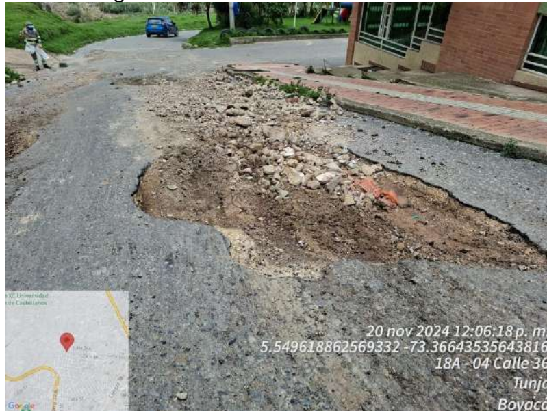
Figura 5. Afectación barrio La Fuente.
