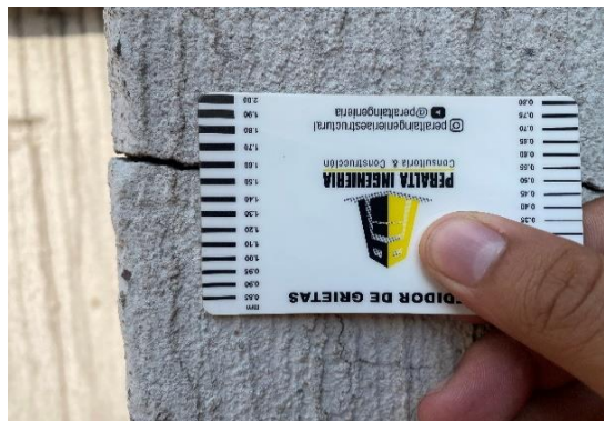
Foto 3. Muro no estructural parque infantil
