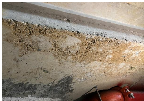
Foto 3. Material no íntegro Viga VDE sótano 2
