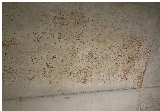
Foto 2. Viga VG-D placa nivel +1,25 sótano 1
