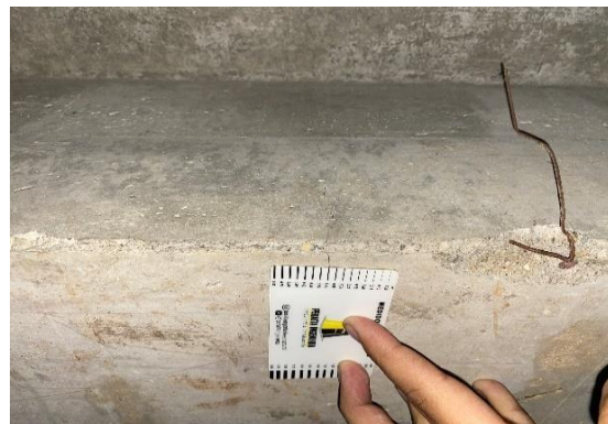
Foto 3. Fisura en viga VG-4 sótano 2
