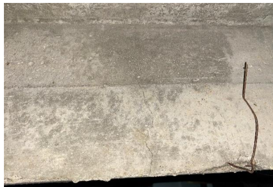
Foto 2. Fisura en viga VG-4 sótano 2
