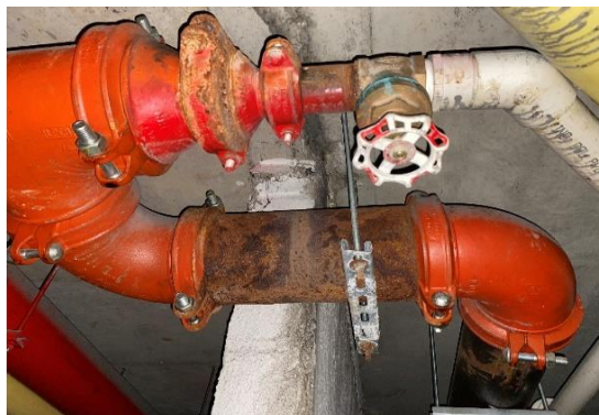
Foto 2. Corrosión tubería RCI sótano 2
