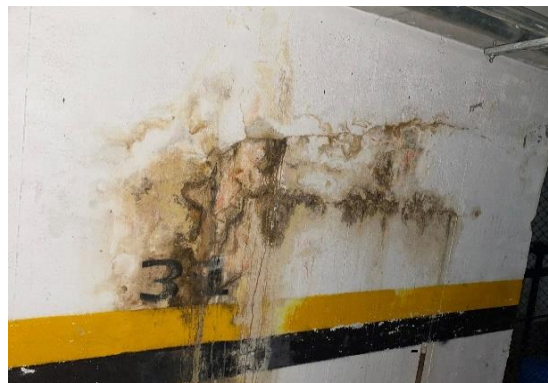
Foto 3. Muro afectado por humedad sótano 2
