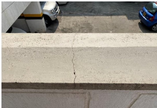
Foto 2. Alfajías en concreto parque infantil piso 2
