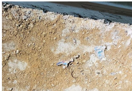
Foto 2. Material no íntegro Viga VDE sótano 2
