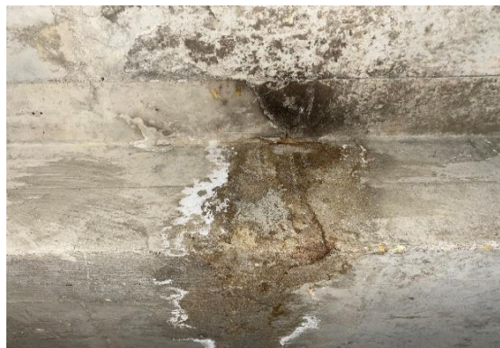
Foto 3. Viga VG-E placa nivel +1,25 sótano 1
