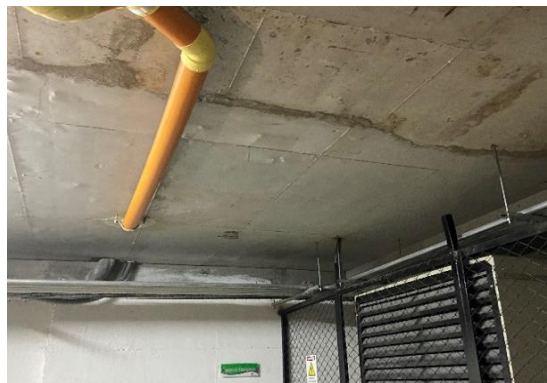
Foto 3. Fisura en placa sótano 2
