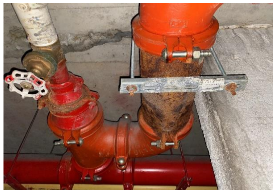
Foto 3. Corrosión tubería RCI sótano 2
