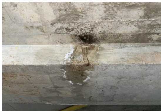
Foto 2. Viga VG-E placa nivel +1,25 sótano 1
