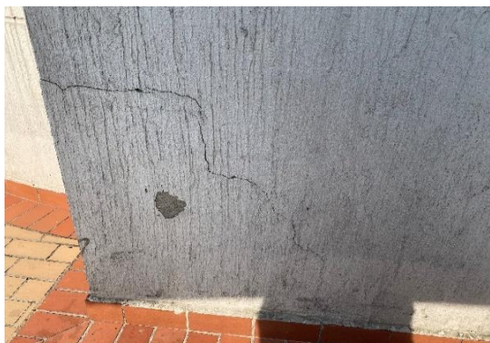
Foto 2. Muro no estructural parque infantil
