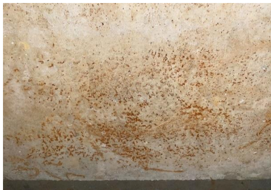
Foto 3. Viga VG-D placa nivel +1,25 sótano 1
