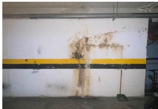
Foto 2. Muro afectado por humedad sótano 2
