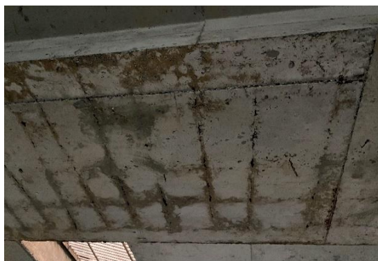
Foto 2. Viga VG-E placa nivel +1,25 sótano 1
