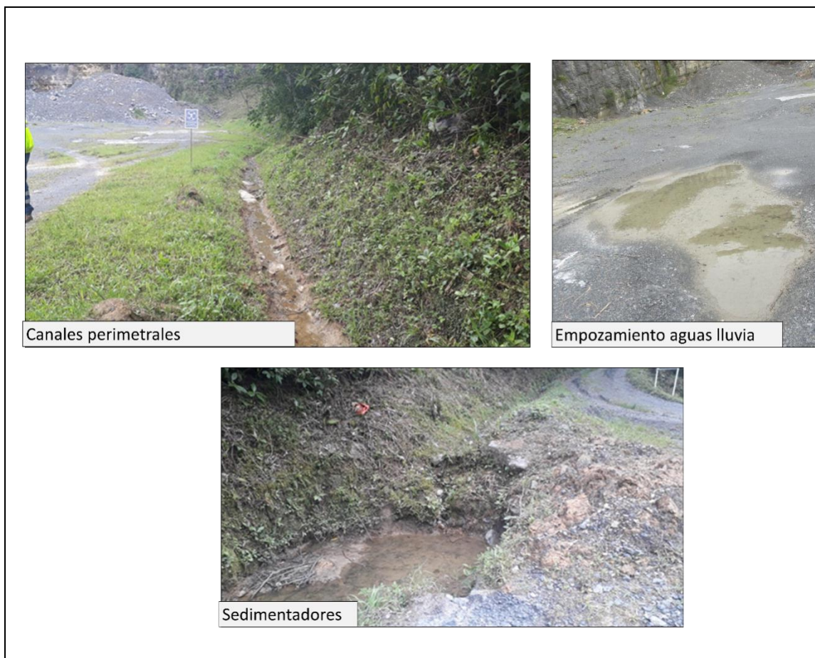
Figura 15. Sobre el manejo de aguas de escorrentía
