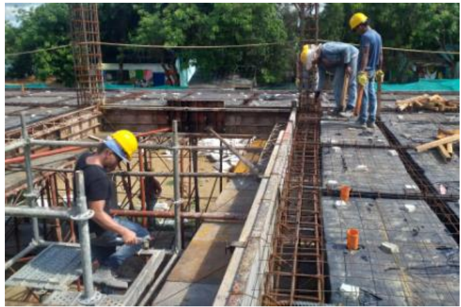
Fotografía 4. Uso inadecuado de EPP
