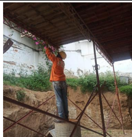
Fotografía 6. Sin medidas adecuadas de seguridad
