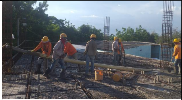
Fotografía 2. Fundida de los de entpiso, trabajadores sin botas adecuadas para fundida de concreto.
