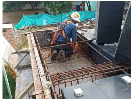
Fotografía 4. Área crítica no señalizada
