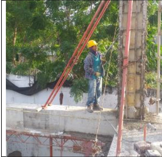
Fotografía 3. Trabajo en altura sin arnes
