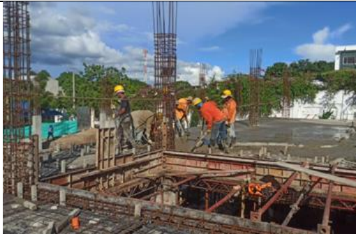
Fotografía 1. Trabajo en alturas, sin arnés de seguridad
