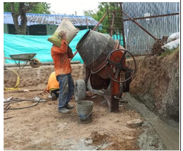
Fotografía 2. Carencia de uso de EPP
