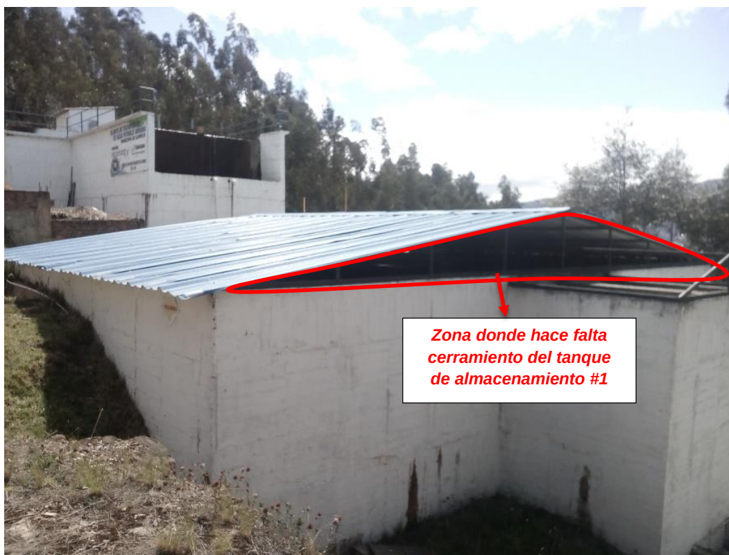
Ilustración 17. Tanque de almacenamiento # 1.
