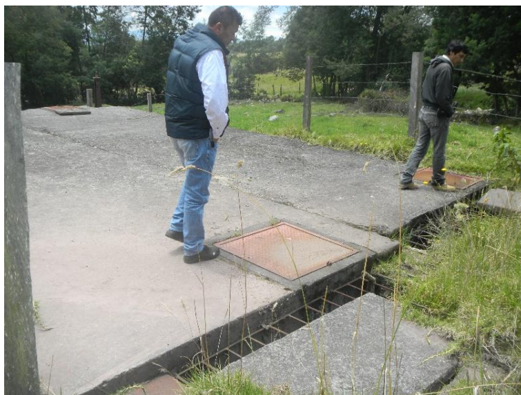
Ilustración 2. Desarenador existente en el acueducto del Municipio de Santa Rosa de Viterbo.
