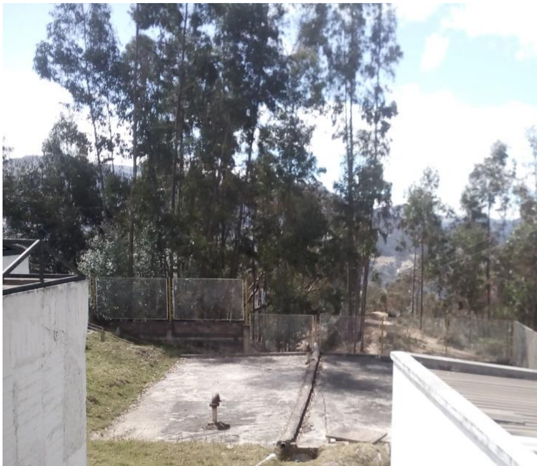
Ilustración 25. Tanque de almacenamiento 2.
