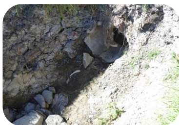
Descarga #1 a potrero en tubería de concreto de D = 16"
