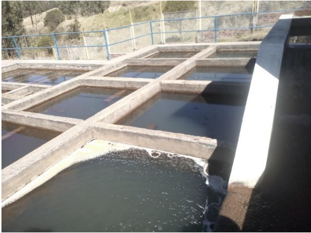
Ilustración 22. Floculación en la PTAP de Gámeza.
