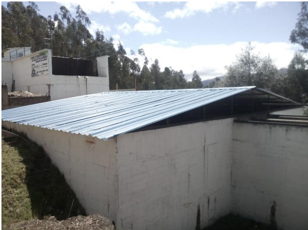
Ilustración 24. Tanque de almacenamiento 1.
