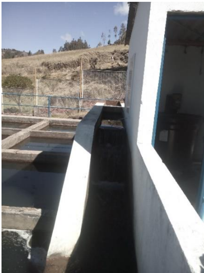
Ilustración 21. Estructura hidráulica para la adición de sulfato.
