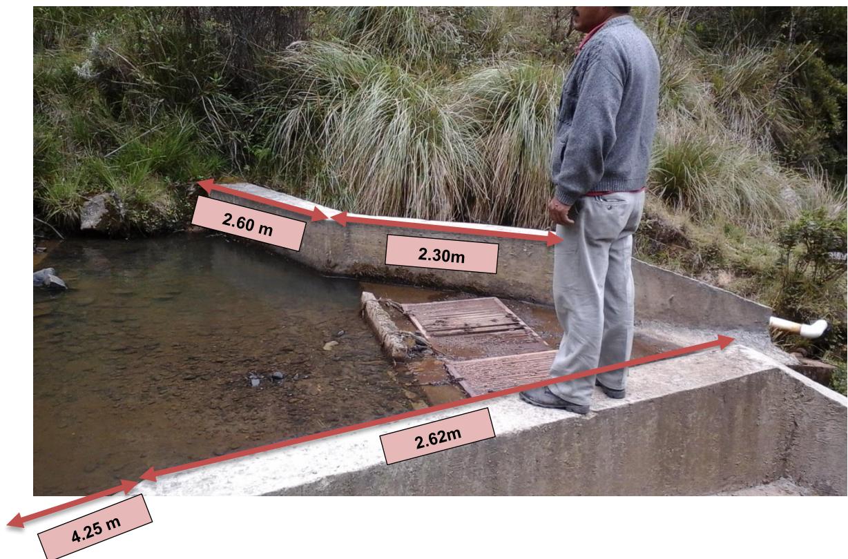
Ilustración 14. Fuente de abastecimiento Quebrada Canelas y bocatoma.
