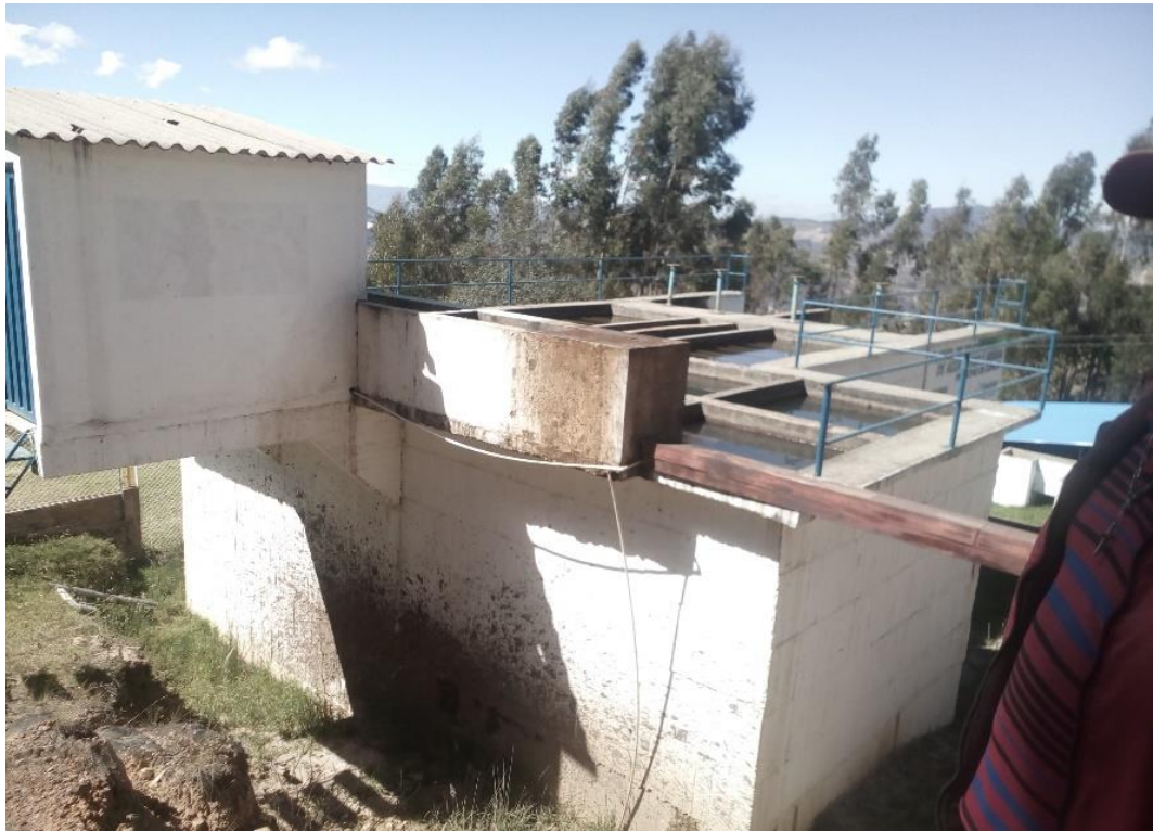
Ilustración 20. Entrada de agua a la PTAP.
